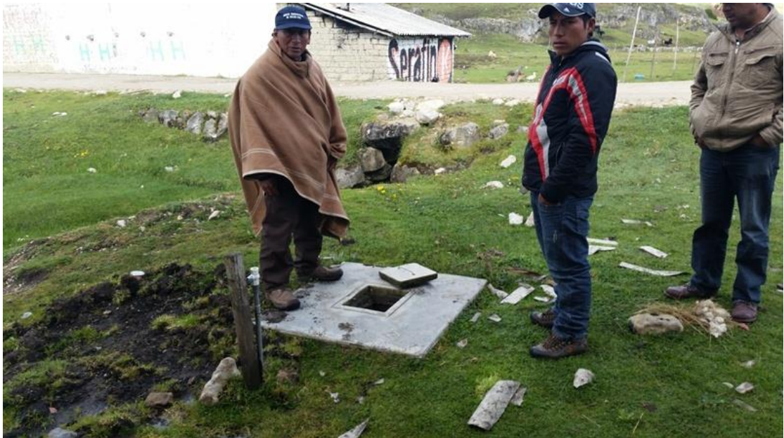
Imagen N° 23: Caja de Agua Existente.
