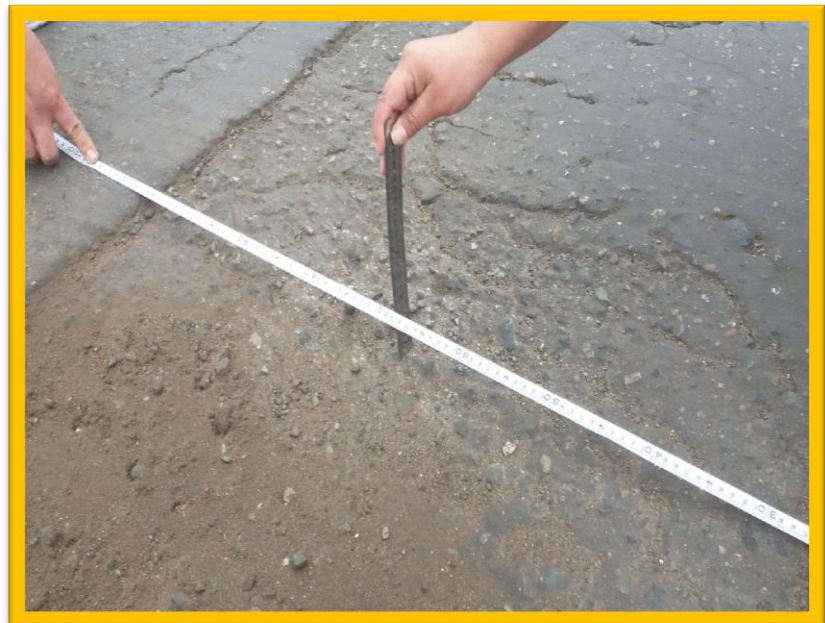
Figura 25: Tomando medidas de la falla elevación y hundimiento
