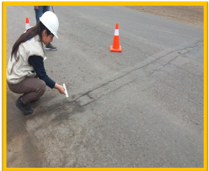
Figura 27: Tomando medidas de la falla parches
