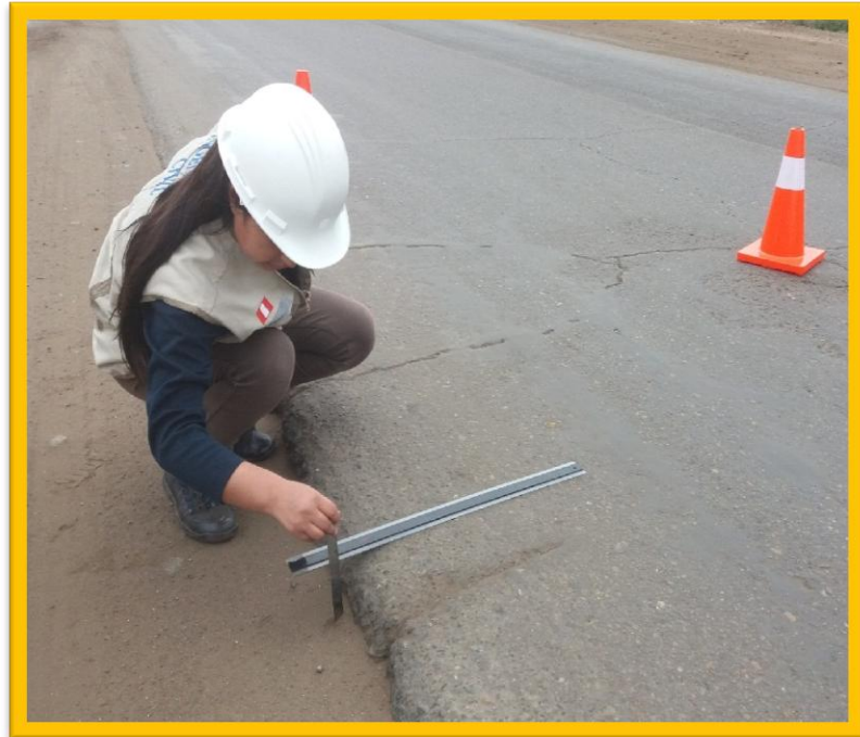
Figura 24: Tomando medidas de la falla desnivel carril/berma
