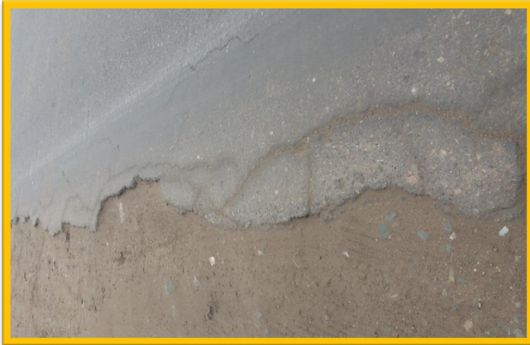
Figura 14: Grietas de borde
