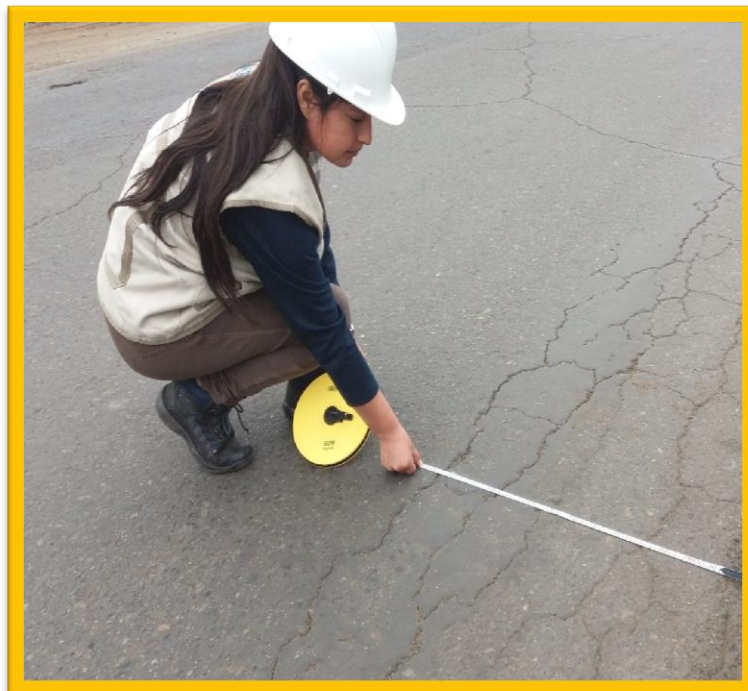
Figura 23: Tomando medidas de la falla piel de cocodrilo
