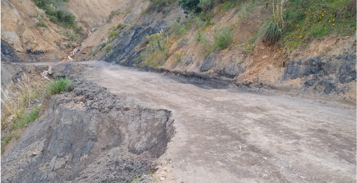
Perdida y erosión de plataforma
