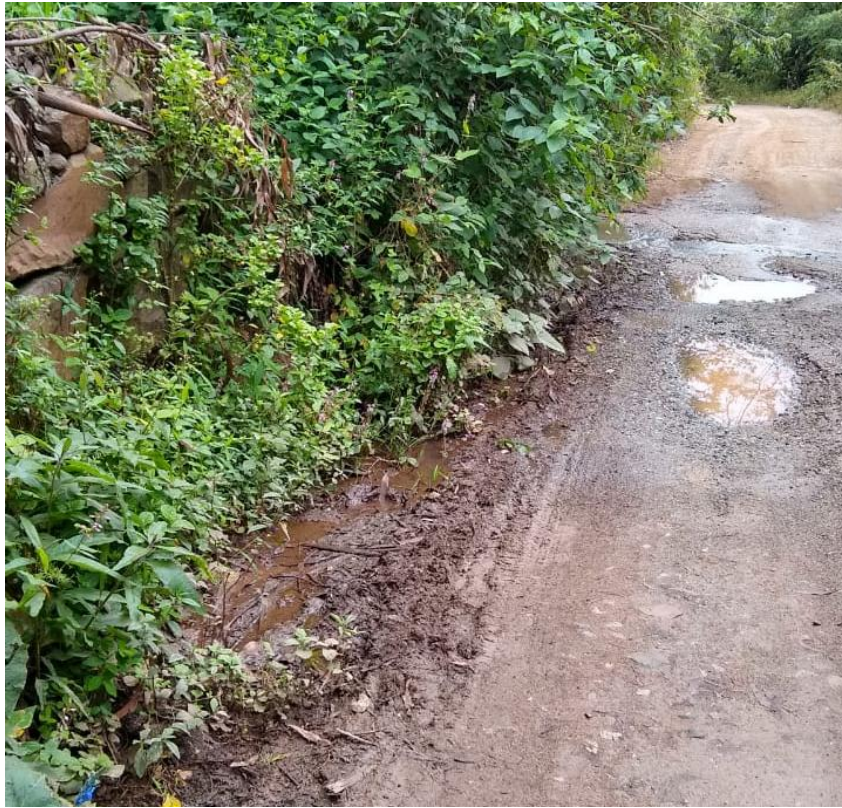
Mal estado de cuneta / falta de desbroce
