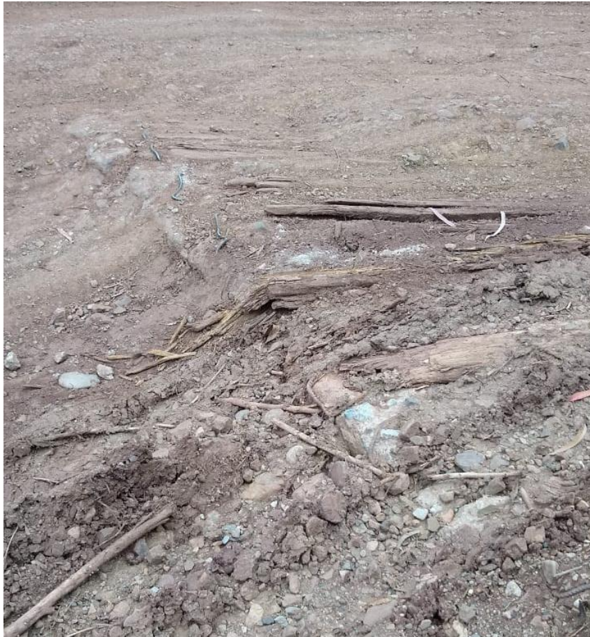
Identificación de Canal de regadío de concreto en deterioro
