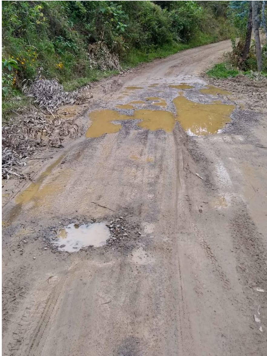
Empozamiento de agua
