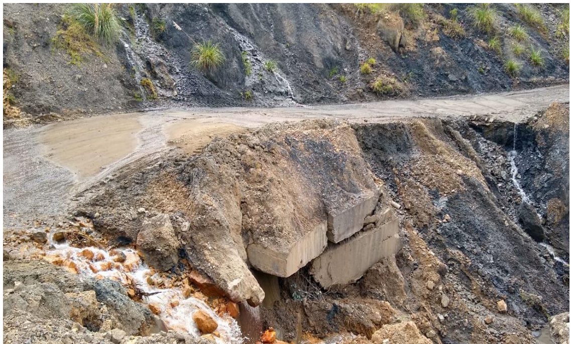
Badén en mal estado
