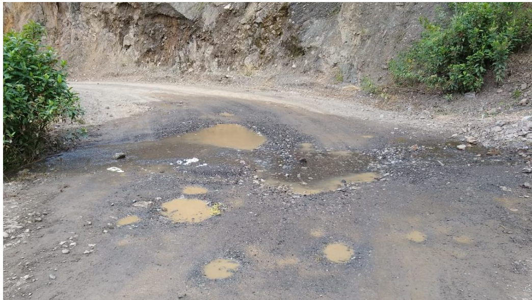
Empozamiento de agua
