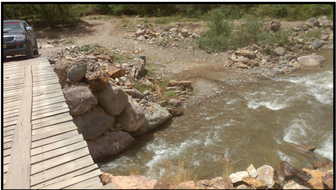
Imagen N° 6: Puente Sinchivin, se observa las bases de los muros de mampostería, en mal estado.
