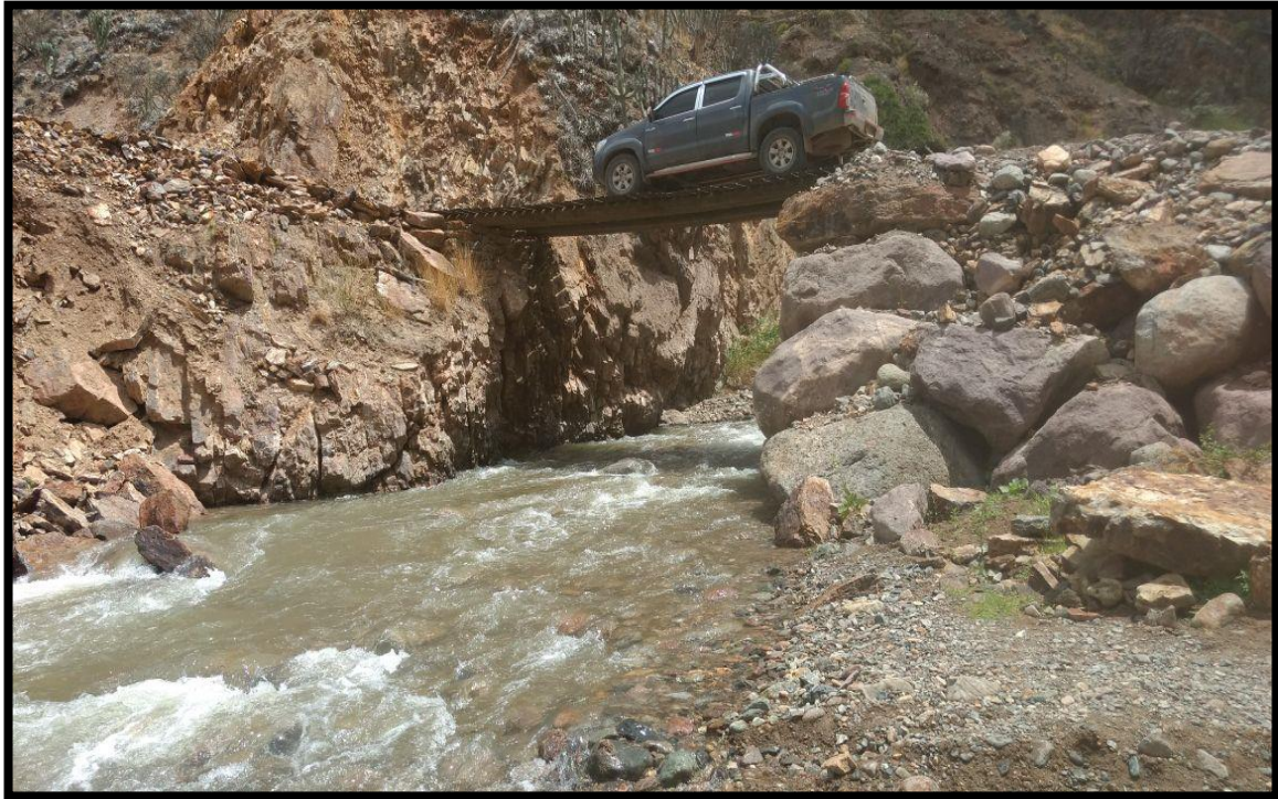
Imagen N° 3: En el Puente Sinchivin, se desmotara la plataforma existente cuales se encuentran socavado, en riesgo de colapso.
