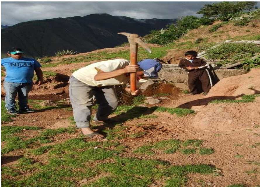
.FIGURA N°3: Vista panorámica de uno de los reservorios construidos más antiguos de la zona donde no tiene abastecido de agua, en ello podemos observar la construcción de un pircado sin ninguna medida de higiene y seguridad.
