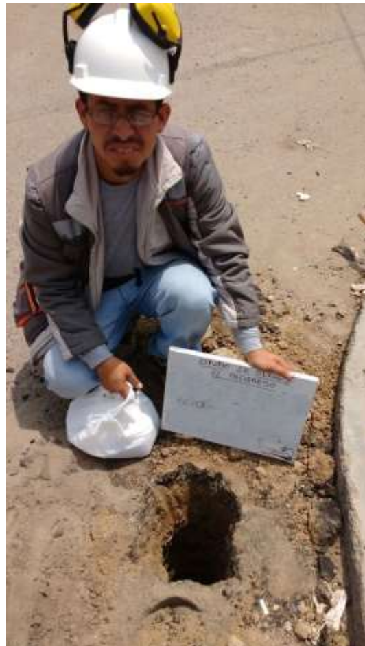
Calicata N° 03: Excavación y extracción de muestras de suelo para ser analizadas en laboratorio.
