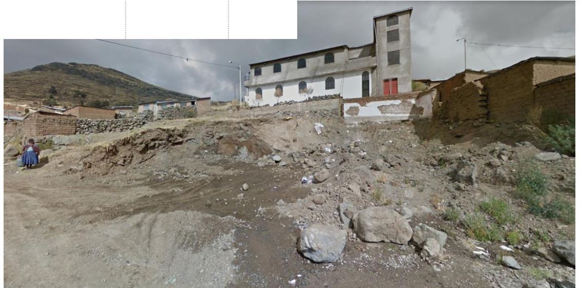
Foto numero 13: viviendas construidas sin muros de contención y sin tomar precauciones de seguridad.
