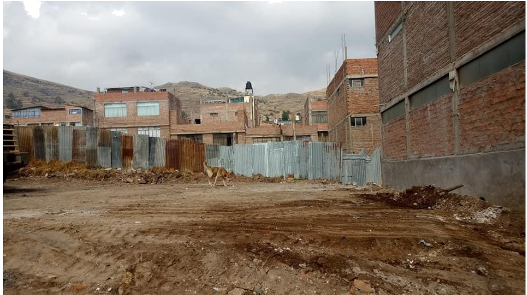
Foto numero 3: material relleno, no apto para la construcción.
