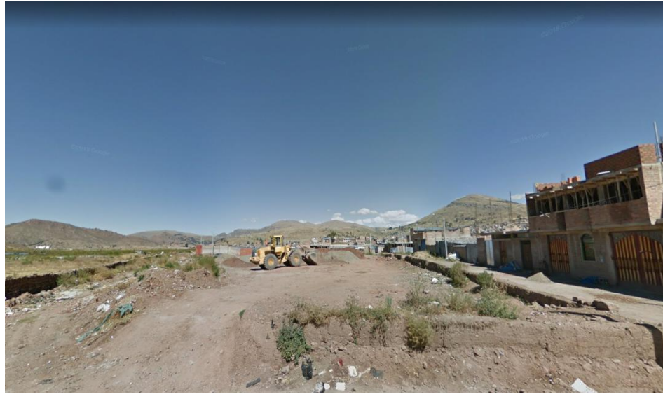
Foto numero 11: residuos de construcción utilizado como relleno.
