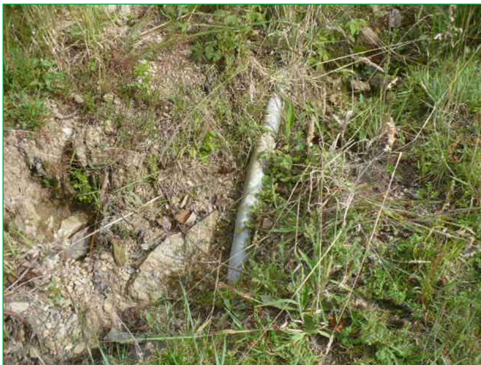
FOTO N° 02: vista panorámica de las tuberías en mal estado puestas por la misma comunidad sin ningún asesoramiento técnico.
