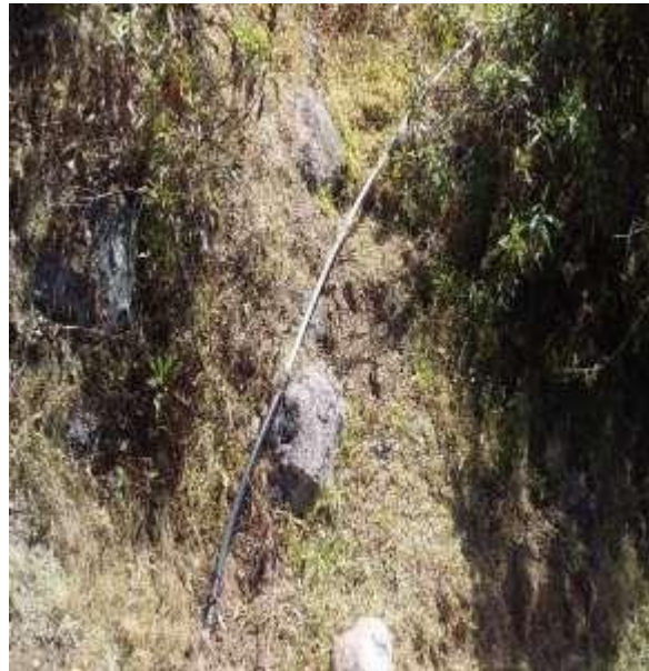
FIG. N°03: el sistema antiguo existente se puso las tuberías a la intemperie, deterioro de su estructura y pérdidas de caudal a causa de fugas
