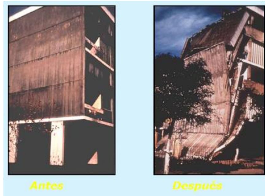
Ilustración 20: Acción de fuerza sísmica en edificio se observa falta de monolitismo.
