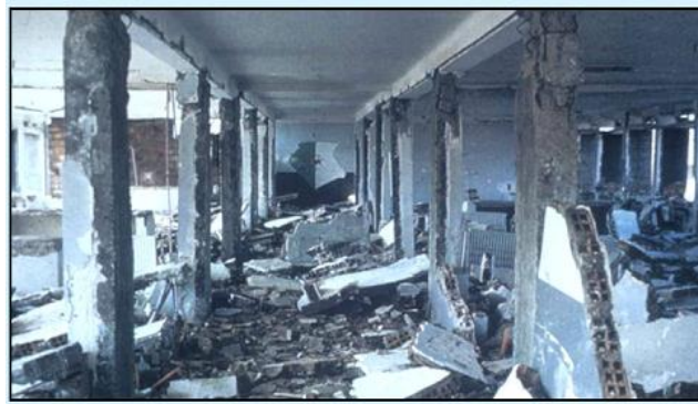
Ilustración 24: Daños producidos por la interacción de elementos estructurales y no estructurales.
