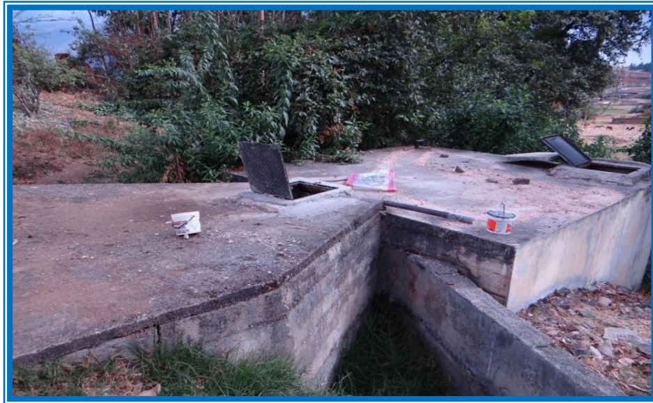
FOTO N°1: Vista panorámica del lugar donde se encuentra la captación, el mal estado de la misa requiere un atención a mejoramiento
