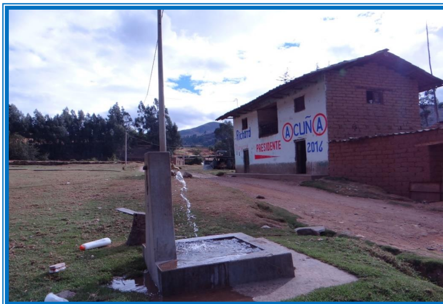
FOTO N° 4: Vista las piletas de aguas instaladas en las viviendas,
