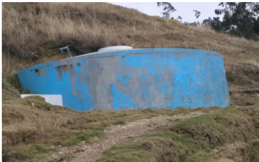
FOTO N°2: vista del reservorio en malas condiciones estructurales, como también un abandono en cuestión la operación y mantenimiento del
