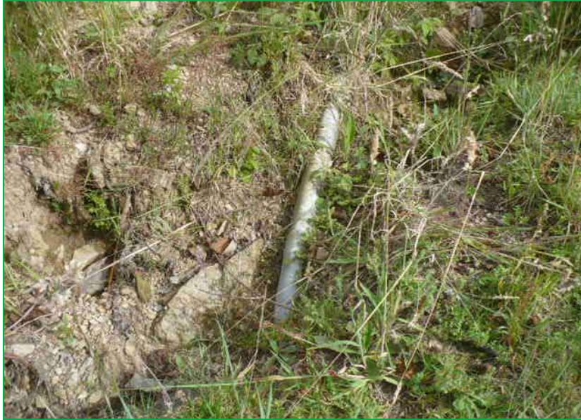
FIGURA 3: VISTA DEL SISTEMA EXISTENTE EN MAL ESTADO COMO ES LA TUBERÍA
