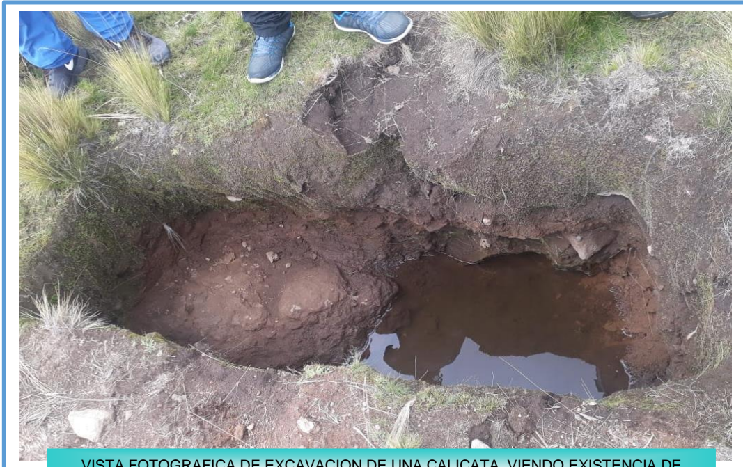
VISTA FOTOGRAFICA DE EXCAVACION DE UNA CALICATA, VIENDO EXISTENCIA DE AGUA EN LA ZONA, LOS CUALES PRODUCTO DE LAS LLUVIAS.
