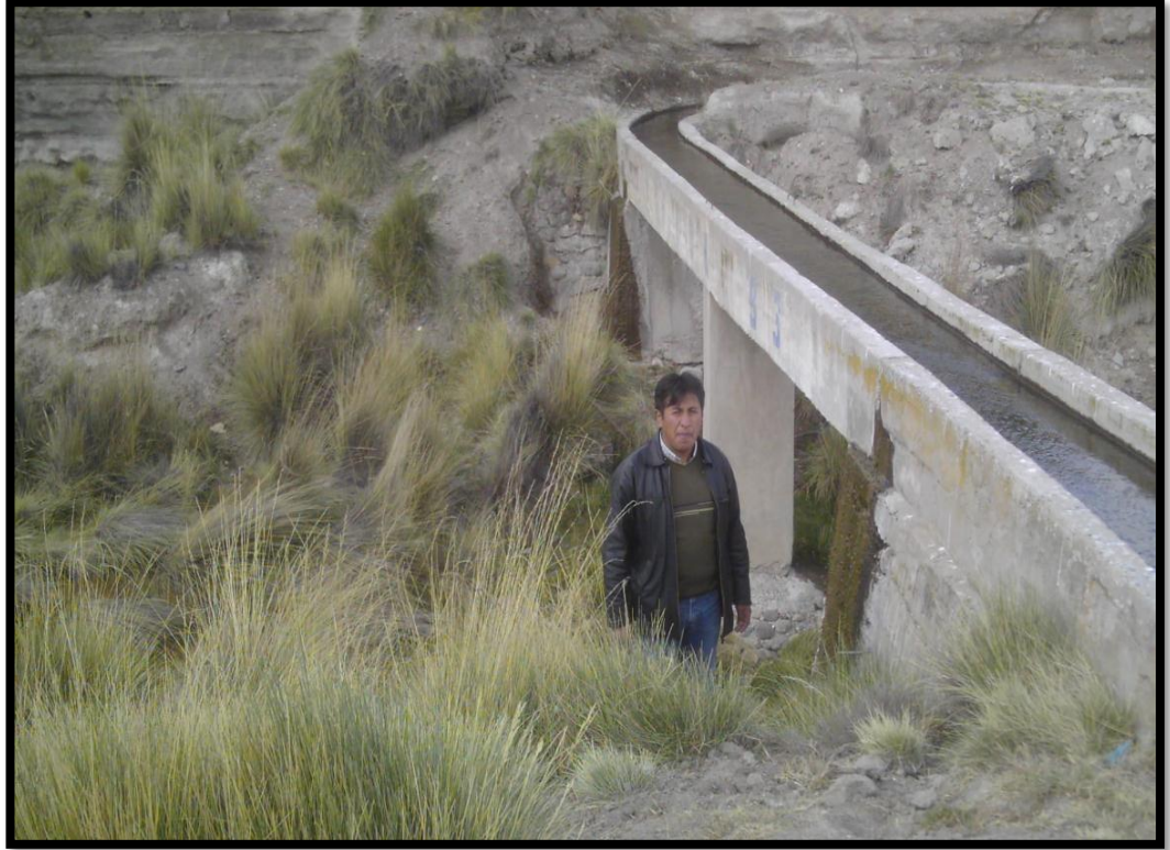
Figura N°03 Se observa en la imagen acueducto con filtraciones
