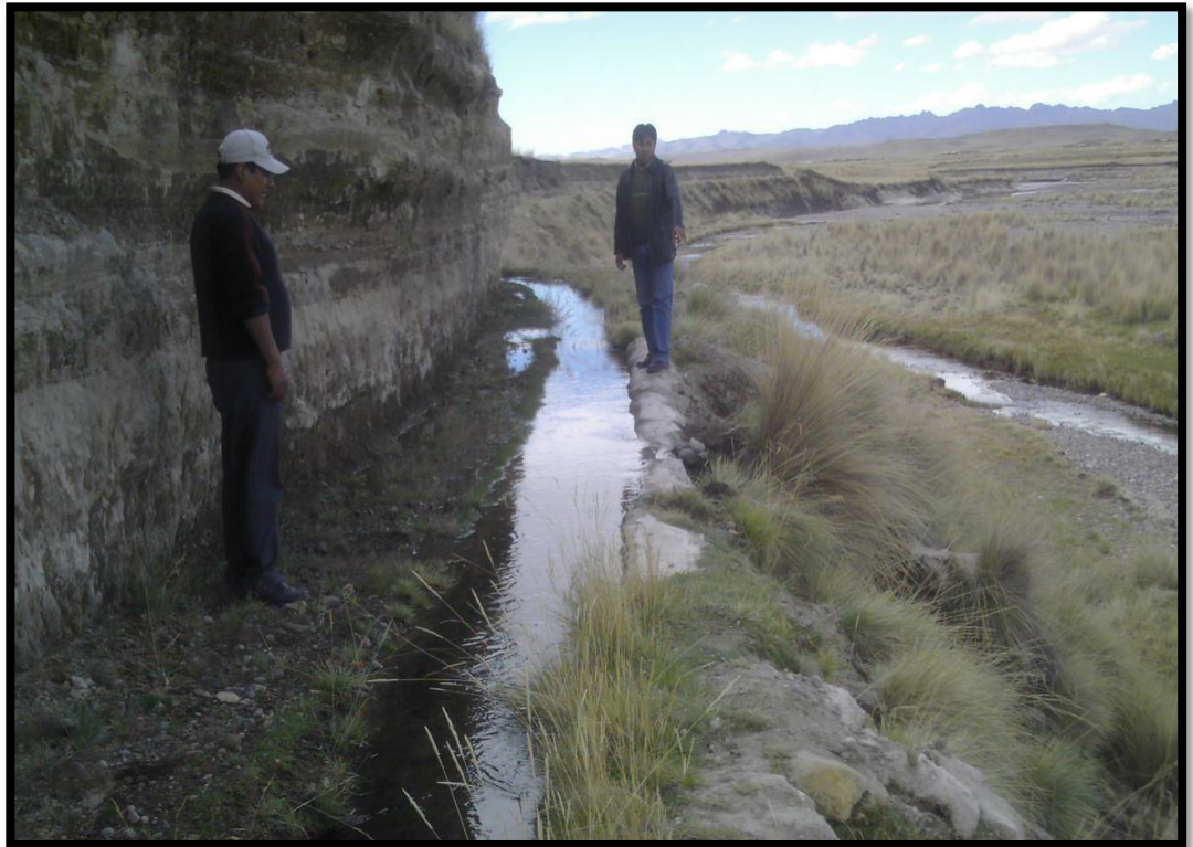
Figura N°04 Se observa en la imagen tramo del canal deteriorado
