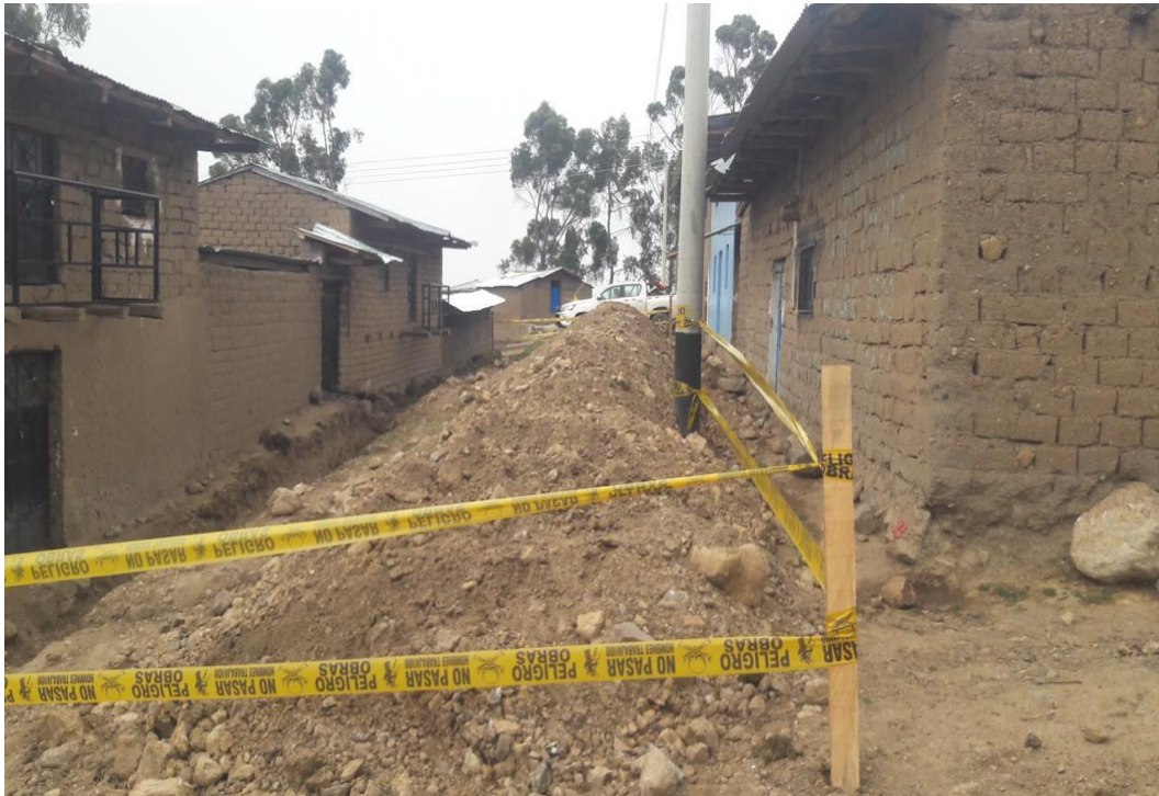
Fotografía N° 11: Demarcación de zona riesgosa (zona de material propio).
