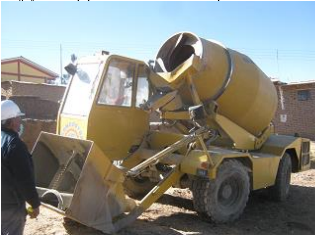
Fotografía N° 9: Equipo Carmix de 3.5 m 3 a utilizarse para la elaboración del concreto.
