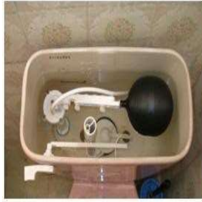
Tanque lleno de agua. La boya horizontal cierra el paso del agua.
