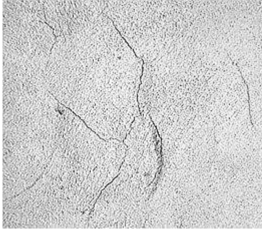
Figura 4. Fisuración por retracción plástica
