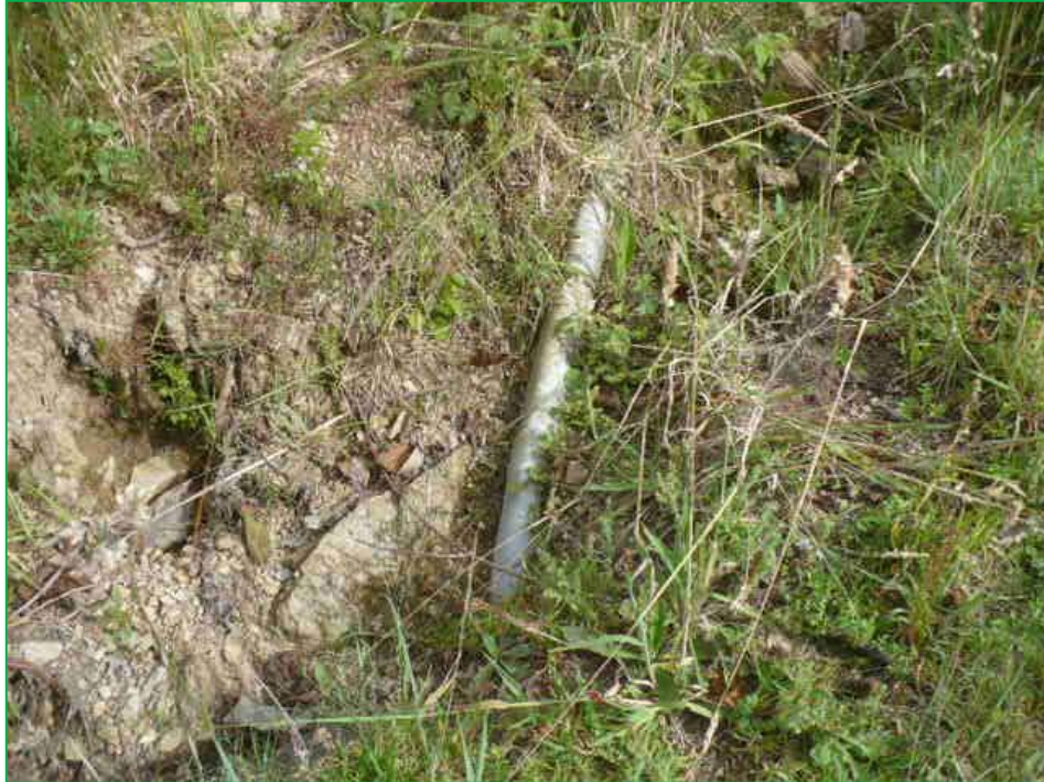
FOTO N° 02: vista panorámica de las tuberías en mal estado puestas por la misma comunidad sin ningún asesoramiento técnico.
