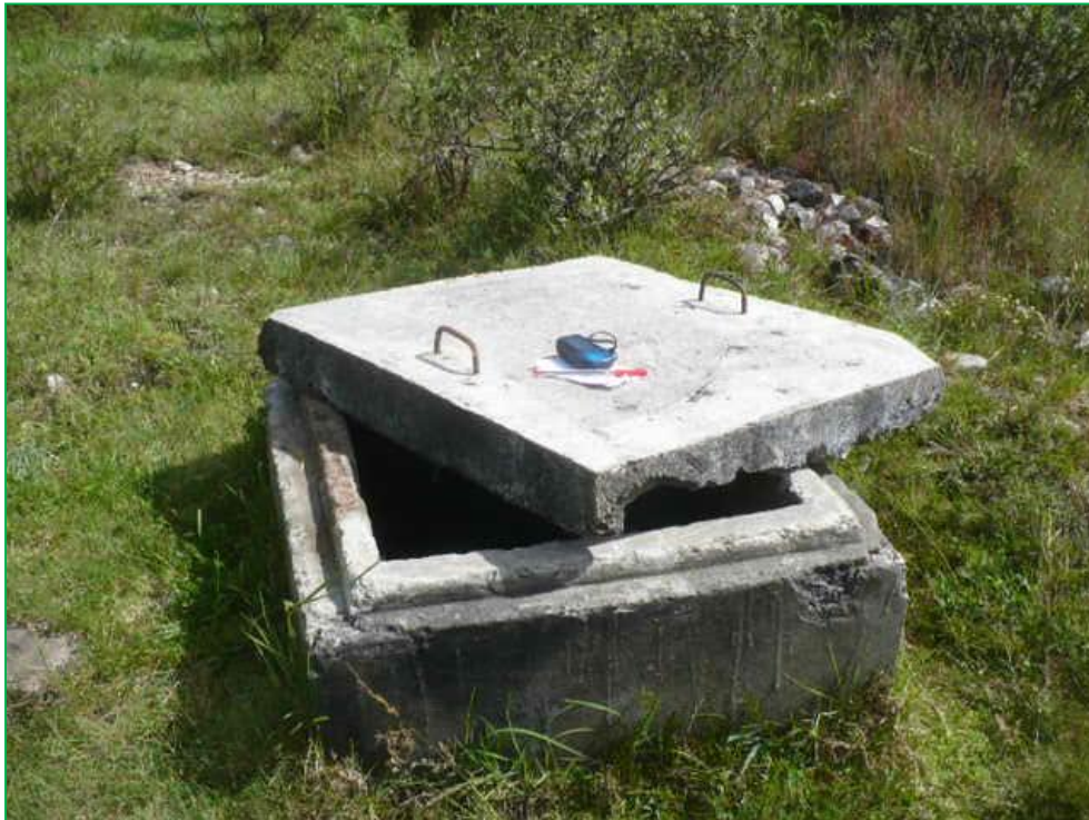
FOTO N° 01: vista panorámica de la estructura construida por los pobladores en malas condiciones y con mucho tiempo de antigüedad
