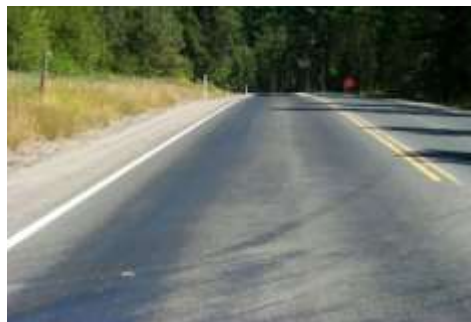
Figura 15: Exudación de Baja severidad
