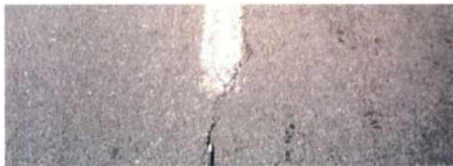
Figura 32: Gravedad 1 Fisuras finas huellas del tránsito (anchos: 1 mm)
