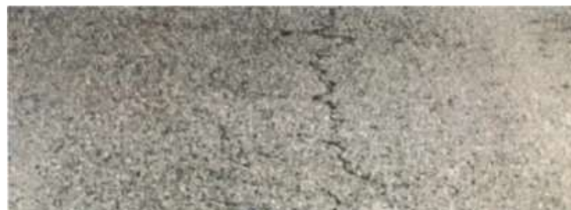
Figura 33: Gravedad 2 fisuras abiertas (ancho > 1 mm y \leq 3 mm)
