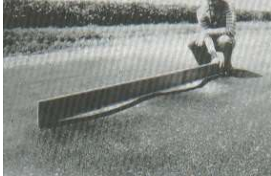
Figura 22: Corrugación de severidad Alta
