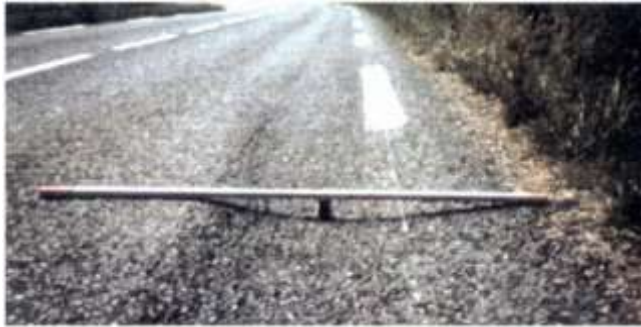
Figura 36: Gravedad 3 Profundidad > 4 cm
