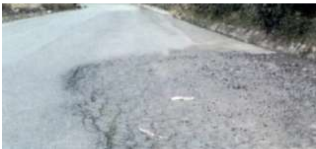
Figura 38: Gravedad 3 Profundidad > 4 cm
