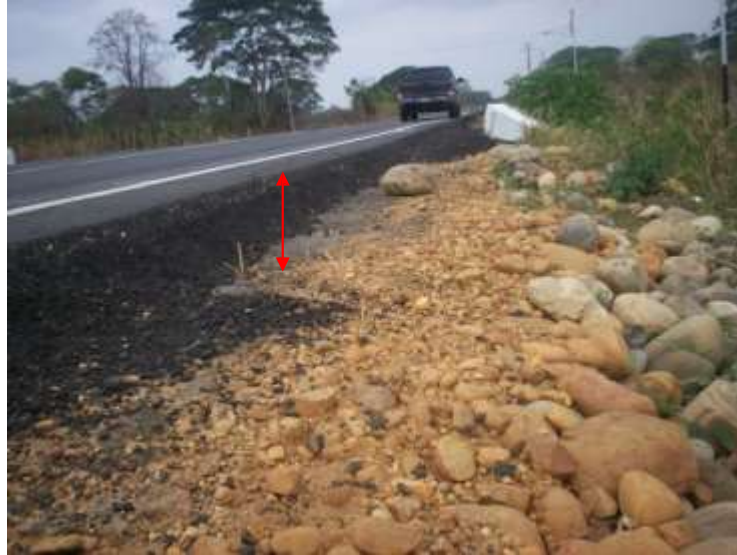
Figura 25: Desnivel carril / berma de severidad media
