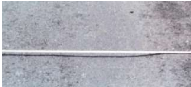
Figura 37: Gravedad 2: Profundidad entre 2 cm y 4 cm
