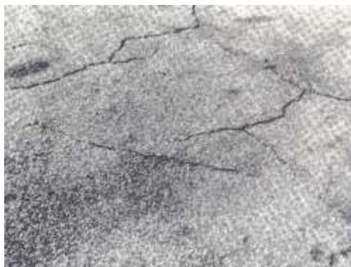
Figura 18: Agrietamiento en bloque de severidad baja
