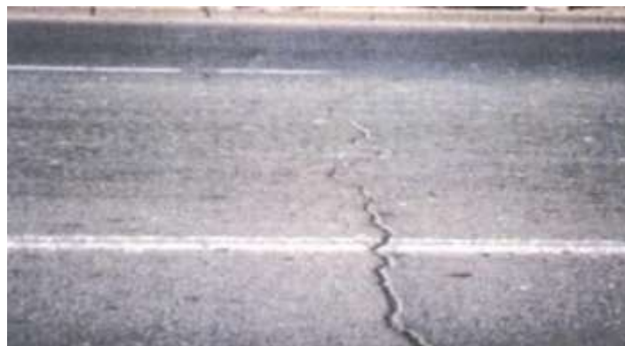
Figura 49 Gravedad 3: Fisuras gruesas (ancho > 3 mm).
