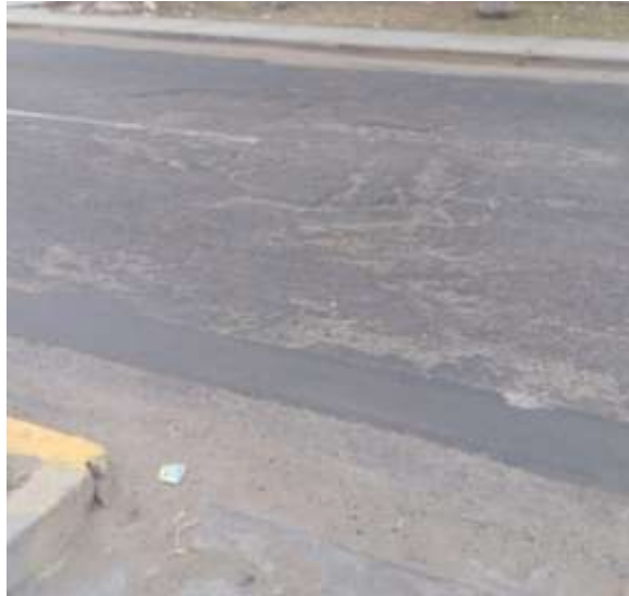
Figura 19: Agrietamiento en bloque de severidad media
