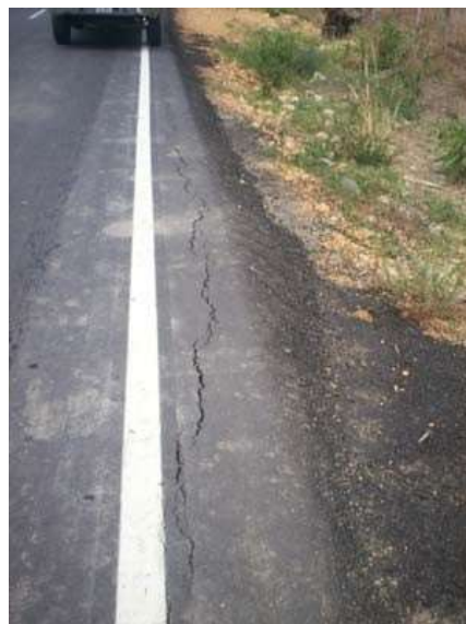
Figura 24: Grieta Borde de severidad media
