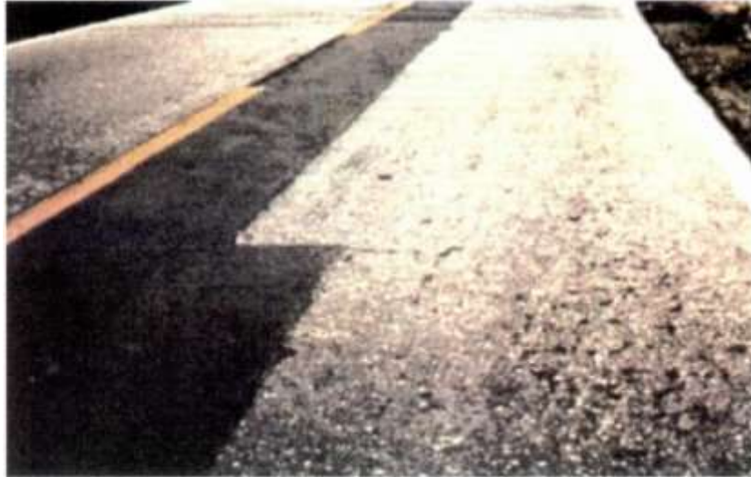
Figura 41: Gravedad 1 Reparación o bacheo para fallas superficiales
