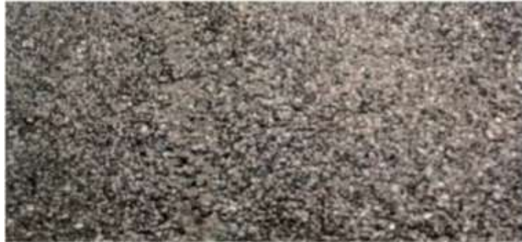
Figura 44: Gravedad 1, Peladura superficial
