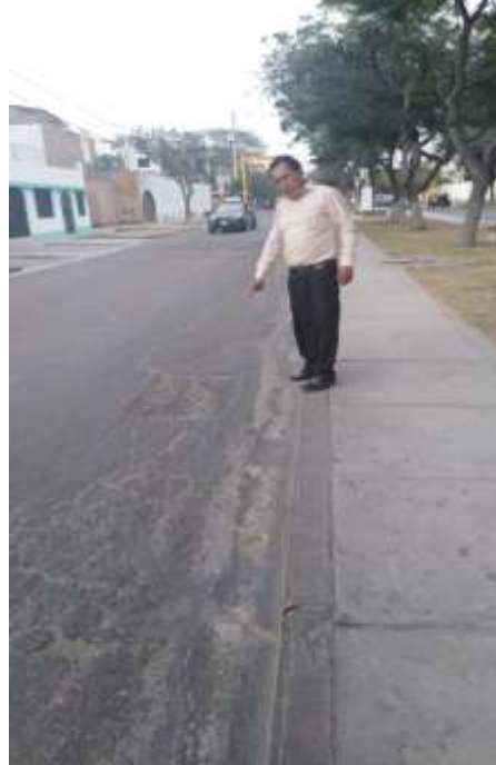
Figura 26: Parcheo de severidad media
