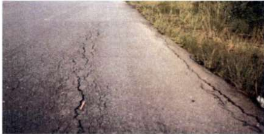
Figura 33: Gravedad 3: Fisuras gruesas (ancho > 3 mm).
