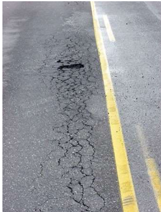
Figura 14: Piel de cocodrilo de severidad alta
