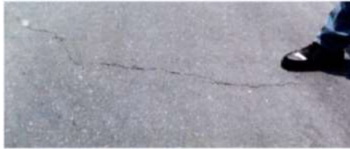
Figura 48 Gravedad 2: Fisuras Medias, con ancho > 1 mm y \leq 3 mm)
