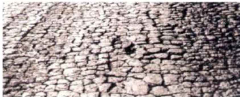
Figura 31: Gravedad 3 Malla pequeña ( < 0.3 m) sin o con material suelto
