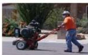
Ruteado de la grieta
