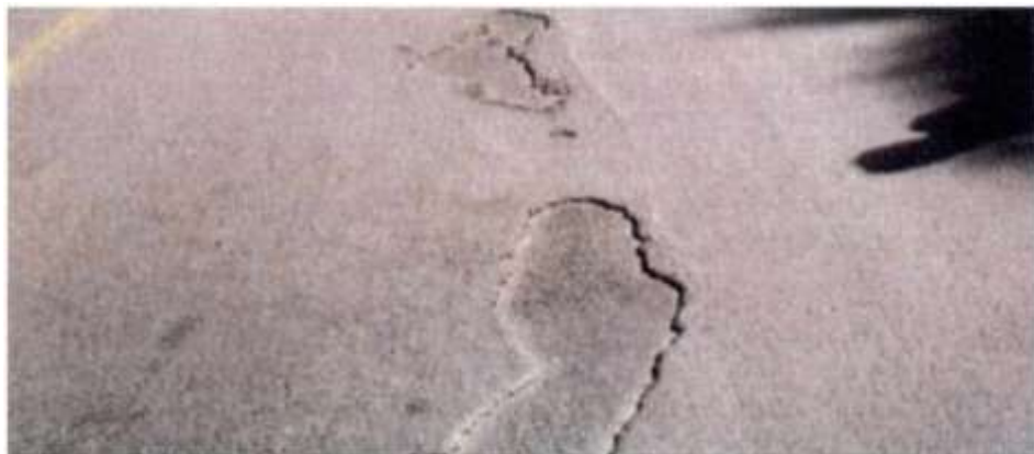
Figura 44: Gravedad 2, Puntual sin aparición de la base granular
