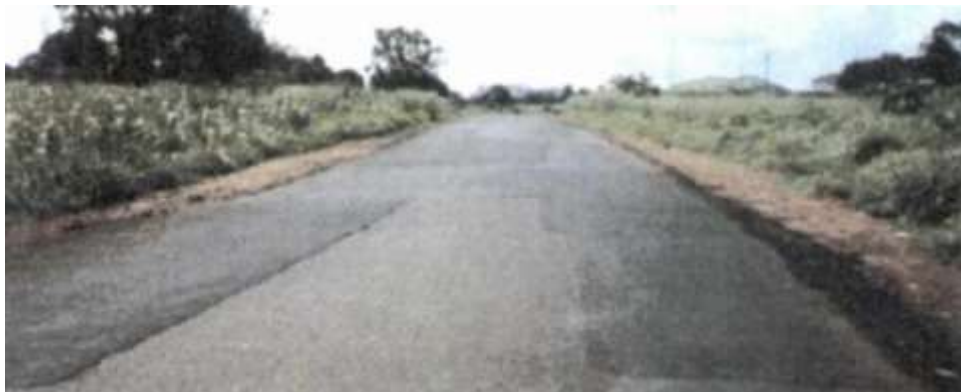
Figura 42: Gravedad 2 Reparación de piel de cocodrilo o de fisuras longitudinales, en buen estado
