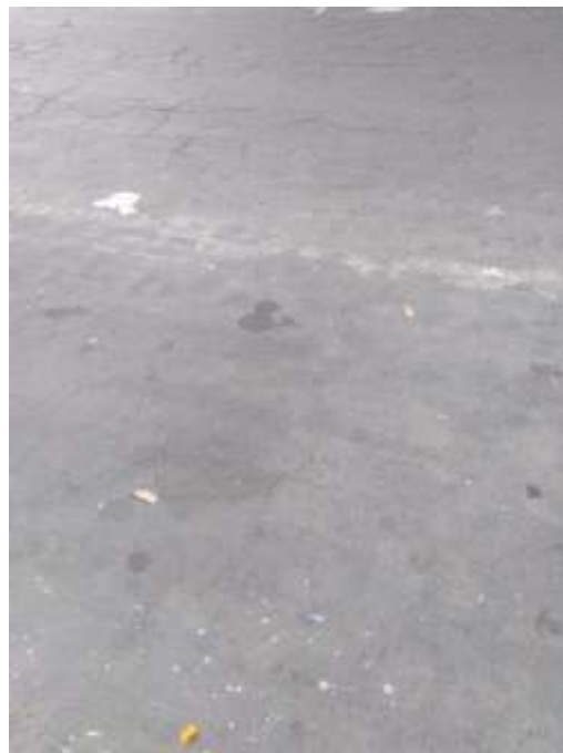
Figura 12: Piel de cocodrilo de baja severidad
