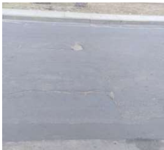
Figura 20: Agrietamiento en bloque de severidad alta
