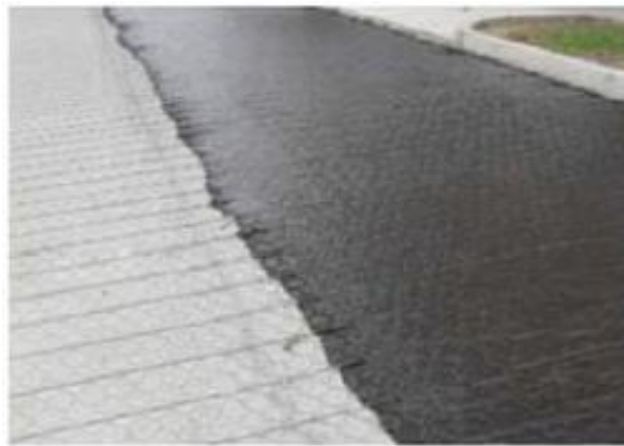
Imagen N° 15: “La aplicación del slurry seal es para obtener una buena adhesión a la capa subyacente”
