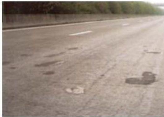
Imagen N° 8: “Levantamiento de Fallas”
