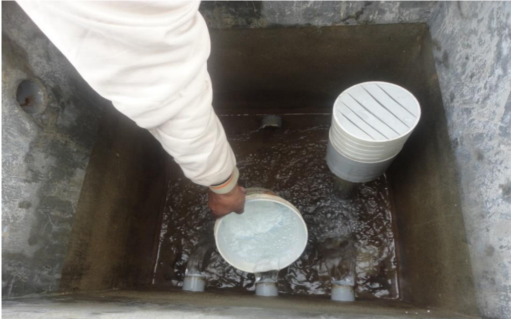
IMAGEN 12: LA IMAGEN MUESTRA EL AFORO REALIZADO A UNA DE LAS CAPTACIONES (LAS PUSHITAS 1) QUE ABASTECEN DE AGUA A LOS SECTORES CHILINORCO Y VAQUERIA
