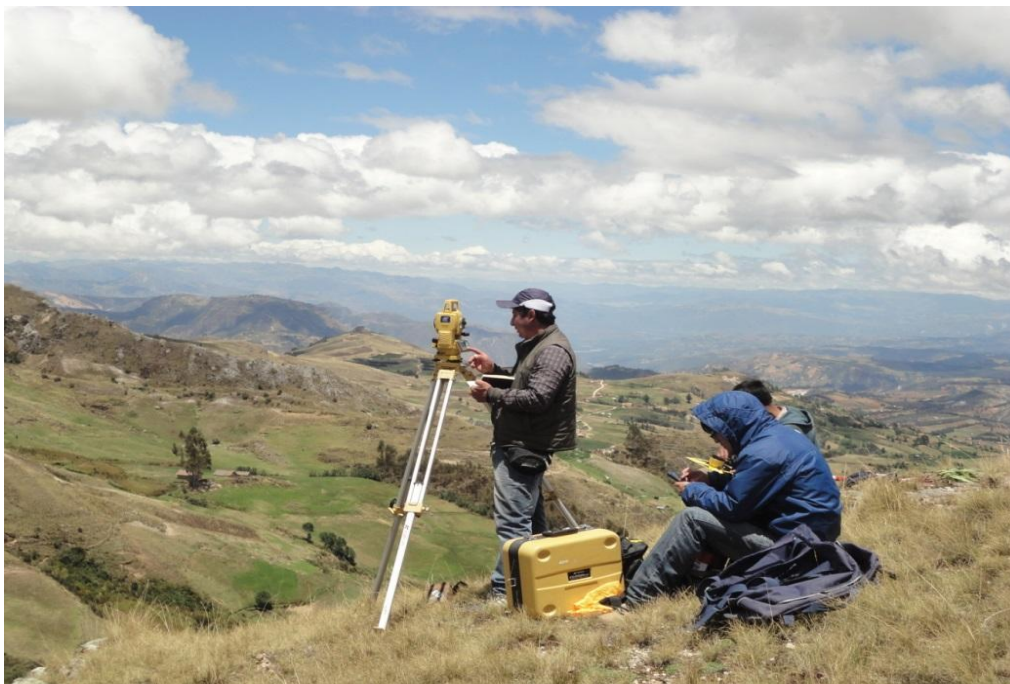
IMAGEN 31: LA IMAGEN MUESTRA LA REALIZACIÓN DE LOS TRABAJOS DE TOPOGRAFÍA EN LA LÍNEA DE CONDUCCIÓN DEL SECTOR PEÑA BLANCA.
