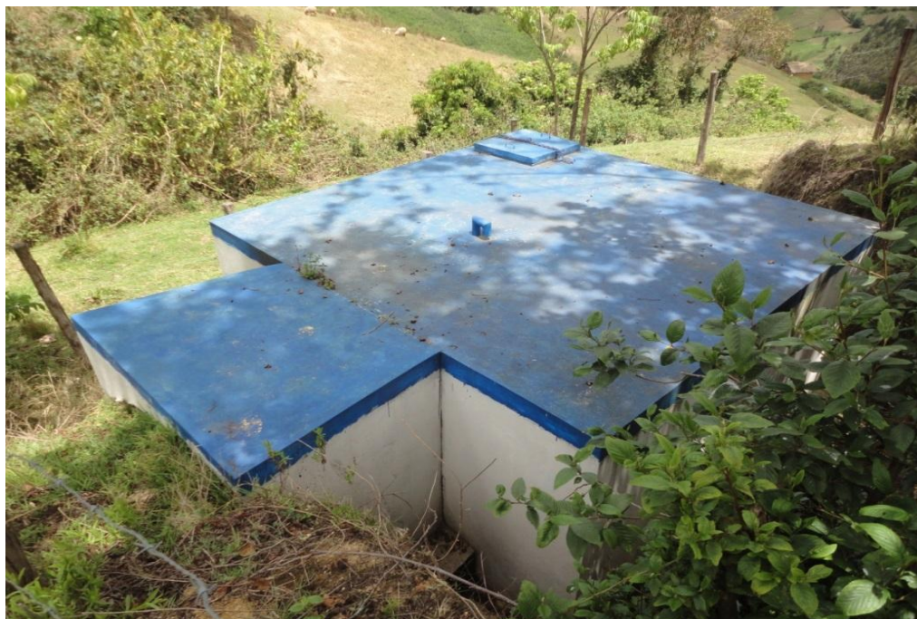
IMAGEN 23 : LA IMAGEN MUESTRA LA FALTA DE PROTECCIÓN Y LIMPIEZA EN EL RESERVORIO ACTUAL QUE ABASTECE AL SECTOR COLPILLA.
