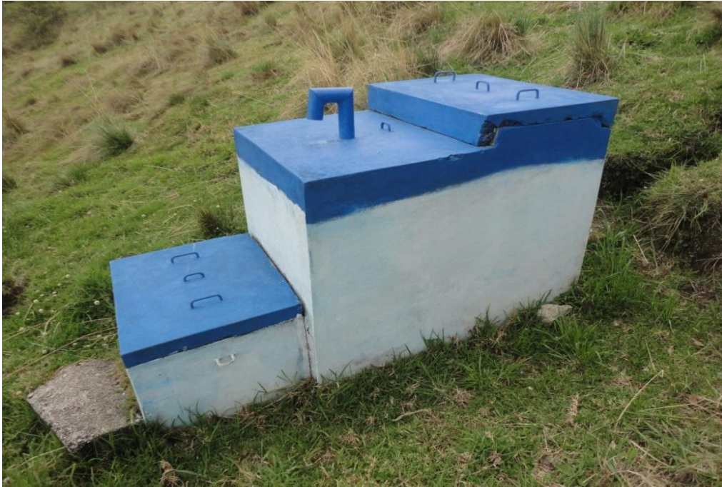
IMAGEN 24: LA IMAGEN MUESTRA LA CAJA DE DISTRIBUCIÓN HACIA UNO DE LOS RAMALES DEL SECTOR COLPILLA.
