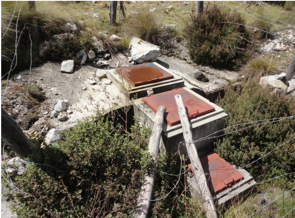
IMAGEN 01: Vistas de la captación N° 01 Las pushitas de los sectores Vaquería y Cholinorco
