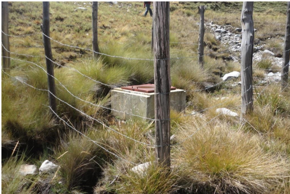
IMAGEN 13 : LA IMAGEN MUESTRA LA CAMARA DE REUNIÓN DE LAS DOS CAPTACIONES QUE APROVISIONAN DE AGUA A LOS SECTORES DE CHILINORCO Y VAQUERIA
