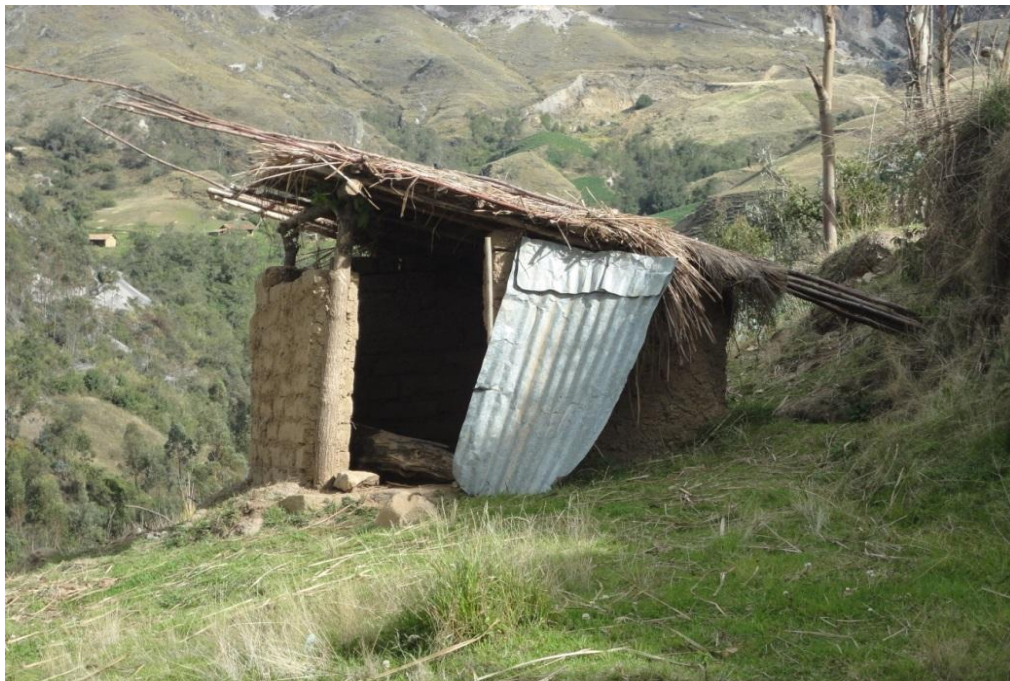
IMAGEN 27: LA IMAGEN MUESTRA EL ESTADO ACTUAL DE LAS LETRINAS SANITARIAS EN EL SECTOR LA COLPILLA.
