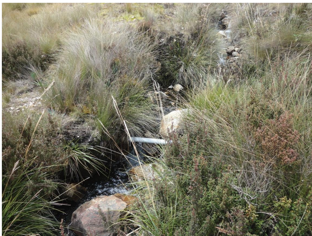
IMAGEN 03: Vistas de tubería de la línea de conducción que es de 2 de los sectores Vaquería y Cholinorco”
