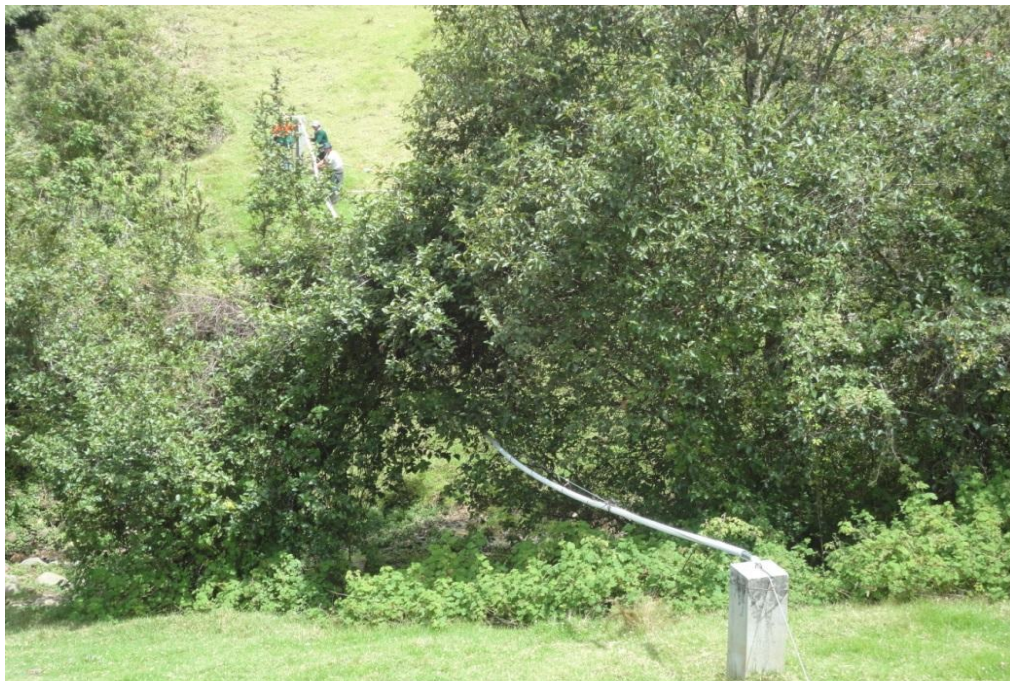
IMAGEN 25: LA IMAGEN MUESTRA LA FALTA DE PROTECCIÓN DE UNO DE LOS PASES AÉREOS QUE CONDUCEN EL AGUA A LAS VIVIENDAS DEL SECTOR COLPILLA.
