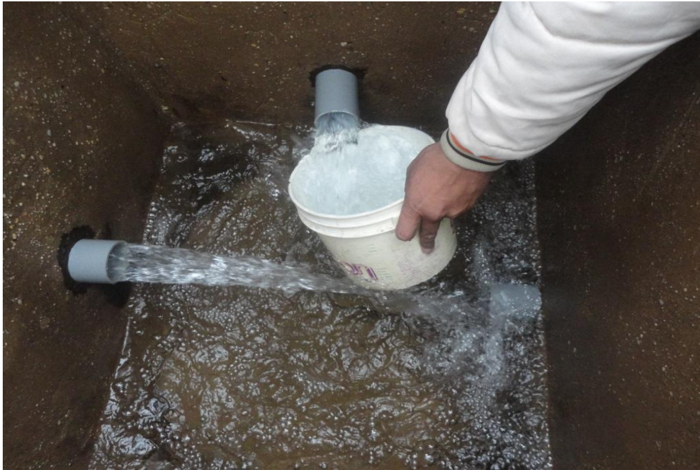
IMAGEN 14: LA IMAGEN MUESTRA EL AFORO REALIZADO EN LA CAMARA DE REUNIÓN DE LAS DOS CAPTACIONES QUE ABASTECEN AL LOS SECTORES CHILINORCO Y VAQUERIA
