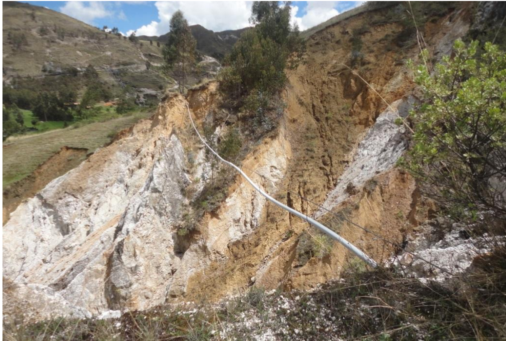
IMAGEN 26: LA IMAGEN MUESTRA LA FALTA DE PROTECCIÓN DE UNO DE LOS PASES AÉREOS QUE CONDUCEN EL AGUA A LAS VIVIENDAS DEL SECTOR COLPILLA.
