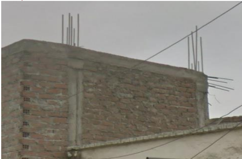
Figura 28: Acero de refuerzo expuestos a la intemperie.
