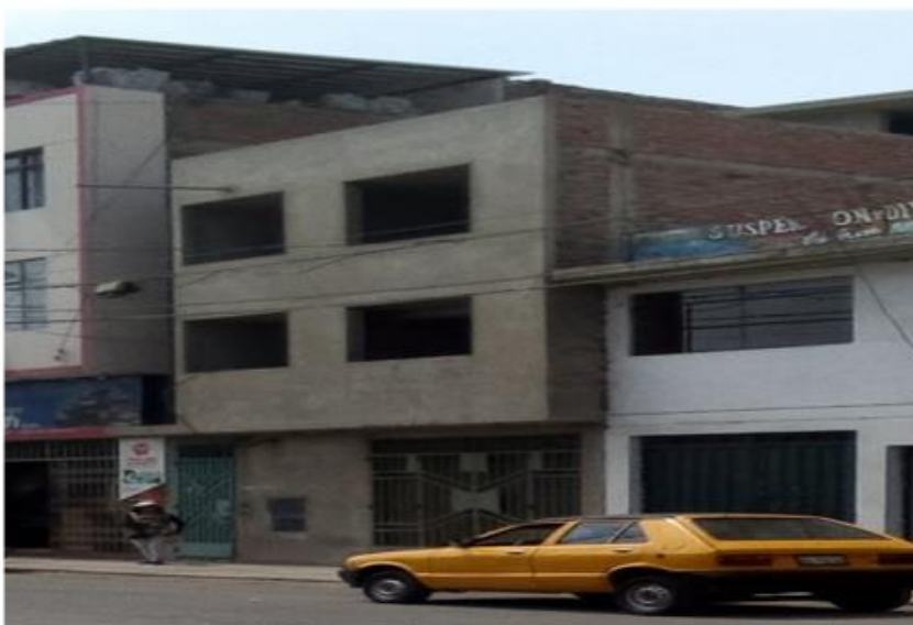
muros deficientes por la calidad del material
