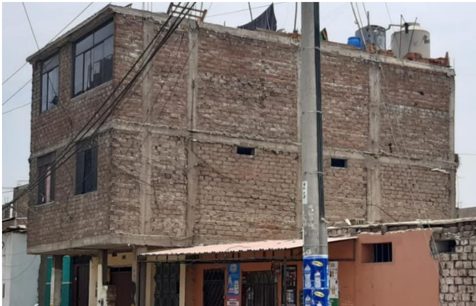
Figura 32: Categorización de Regular a mala calidad de mano de obra.
