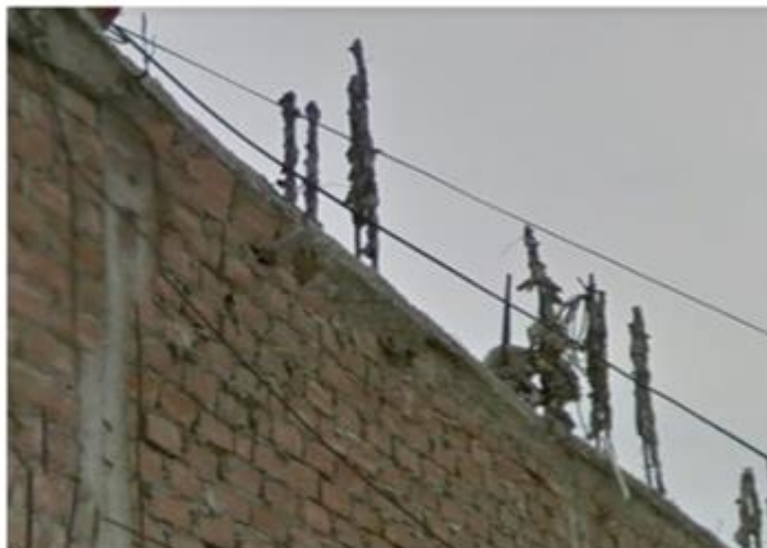
Muro con deficiencias en el asentado de ladrillo
