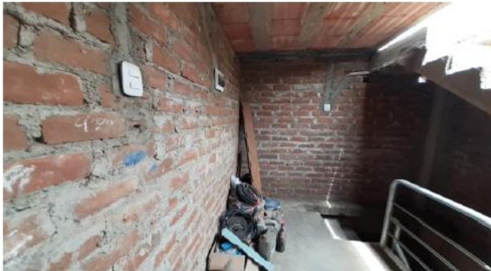
Muro con juntas mayor a 1.5 cm y armadura corroida en la escalera
