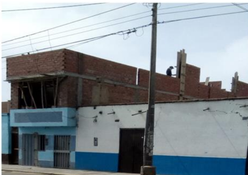
Poco densidad de muros en el eje X-X 2° nivel
