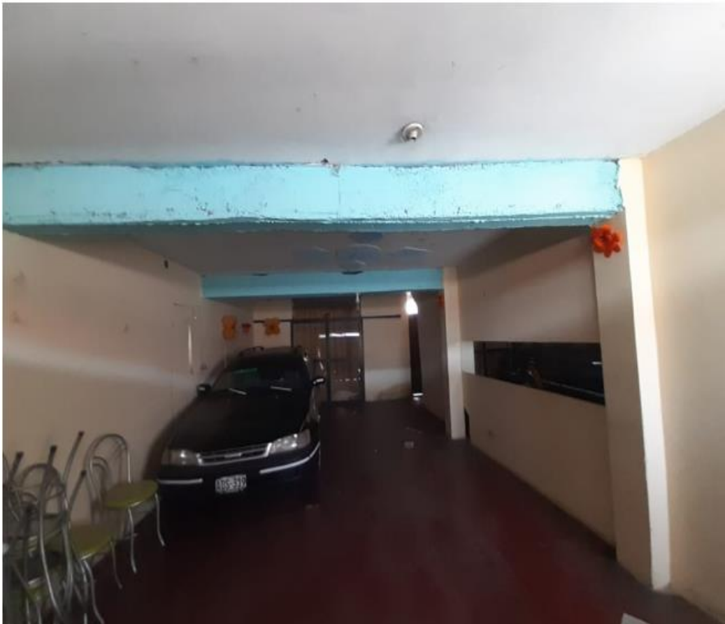
Figura 23: Inadecuada densidad de muros en primer piso
