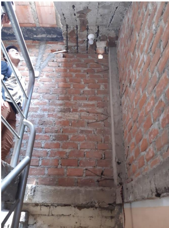
Figura 29: Armadura corroída en la escalera.
