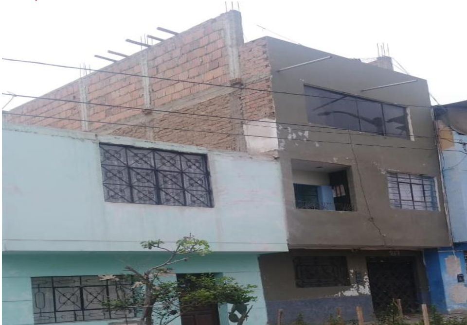
Figura 27: Cambio brusco en la rigidez lateral por el empleo de otra propiedad del ladrillo.
