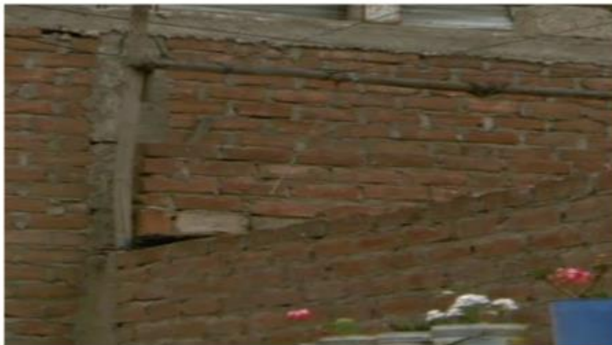
deficiencia en el asentado de ladrillo, concreto pobre en columnas
