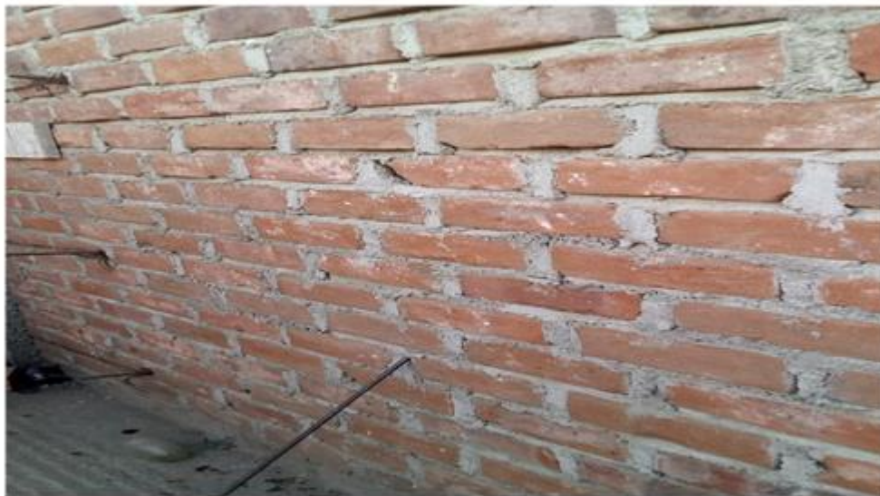
Muro con juntas mayor a 1.5 cm y armadura corroida en la escalera
