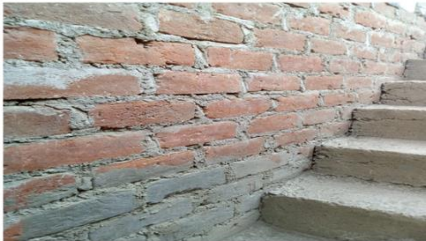
Muro con juntas mayor a 1.5 cm y armadura corroída en la escalera
