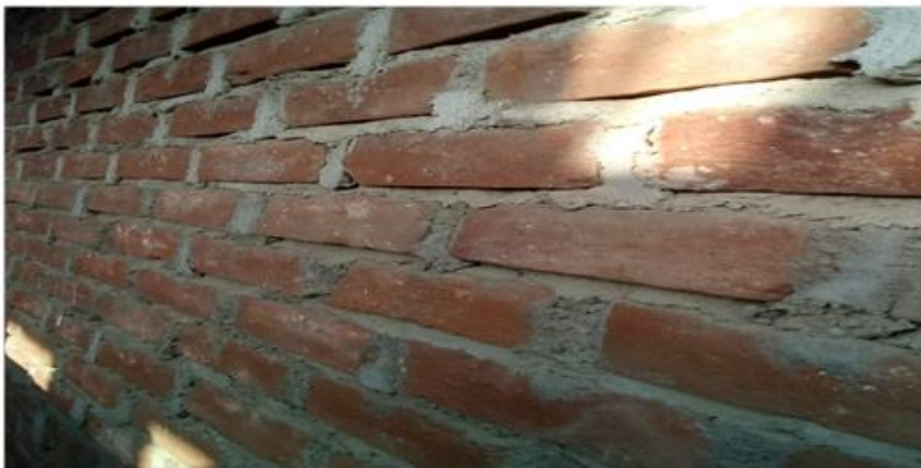
Muro con juntas mayor a 1.5 cm
