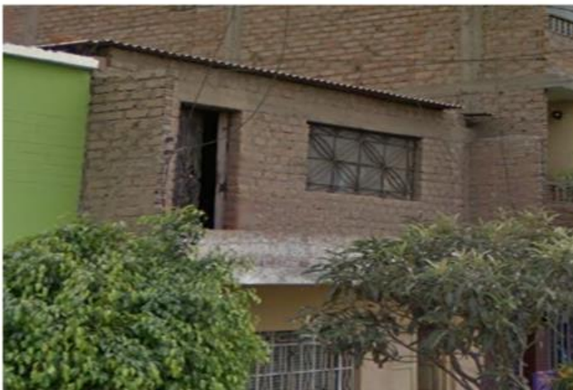
Muro con juntas mayor a 1.5 cm, presentando fisuras verticales
