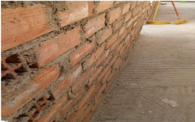
Muro con juntas mayor a 1.5 cm
