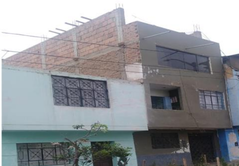
muros deficientes por la calidad del material
