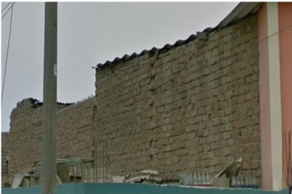
Muros sin arriostamiento
