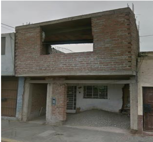
Figura 31: Categorización de Regular a mala calidad de mano de obra.
