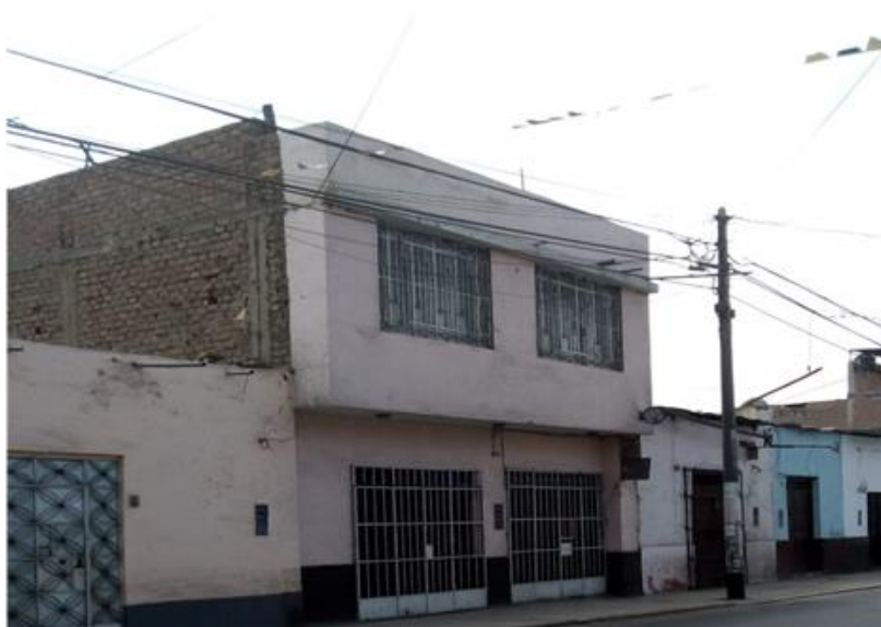
muros deficientes por la calidad del material
