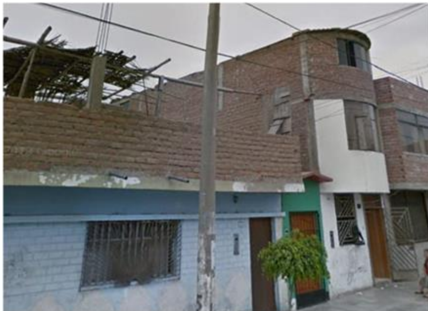
muros tercer nivel con falta de arriostramiento en la parte superior
