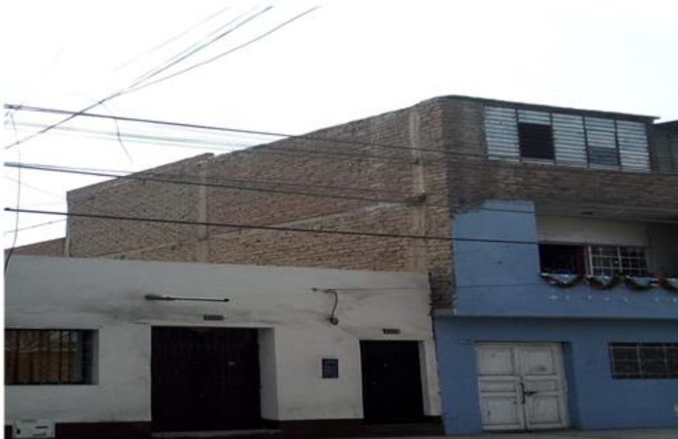
muros deficientes por la calidad del material
