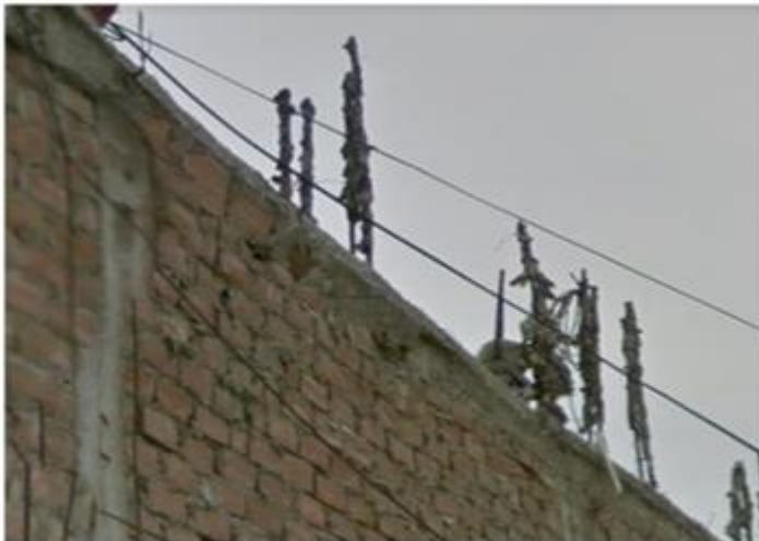
Muro con juntas mayor a 1.5 cm, presentando fisuras verticales
