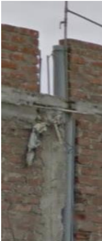
Figura 33: Tubería PVC de desagüe expuesta.
