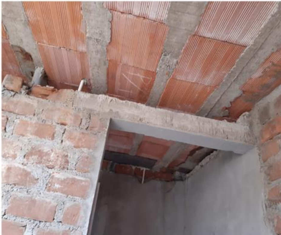
Juntas mayores a 1.5 cm, e inestabilidad de tabiques
