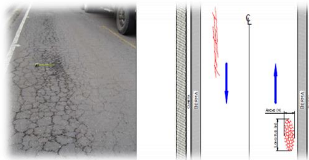
Figura 2: Fisura Piel de Cocodrilo
