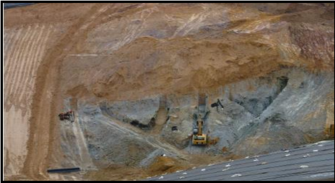
Vista de excavación y limpieza de zanjas para sub drenaje en el talud este de Fase 2
