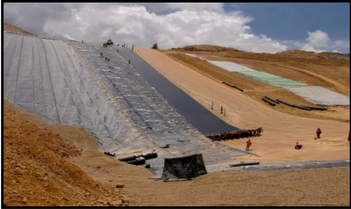
Vista del despliegue de cuatro paneles de Geomembrana en el Talud sur del Pad Fase 2
