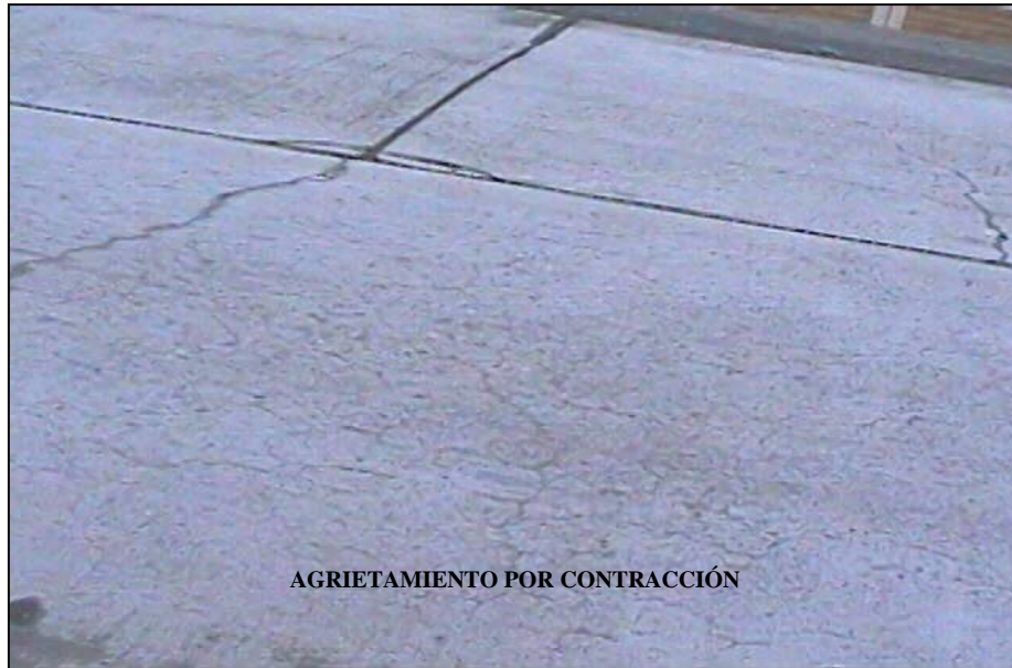
Figura N°12. Agrietamiento de Contracción
