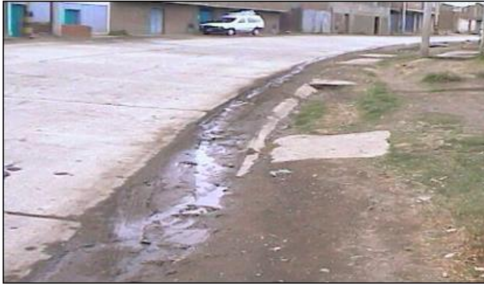
Figura N°08. Cuneta colmatada, el agua discurre sobre la
