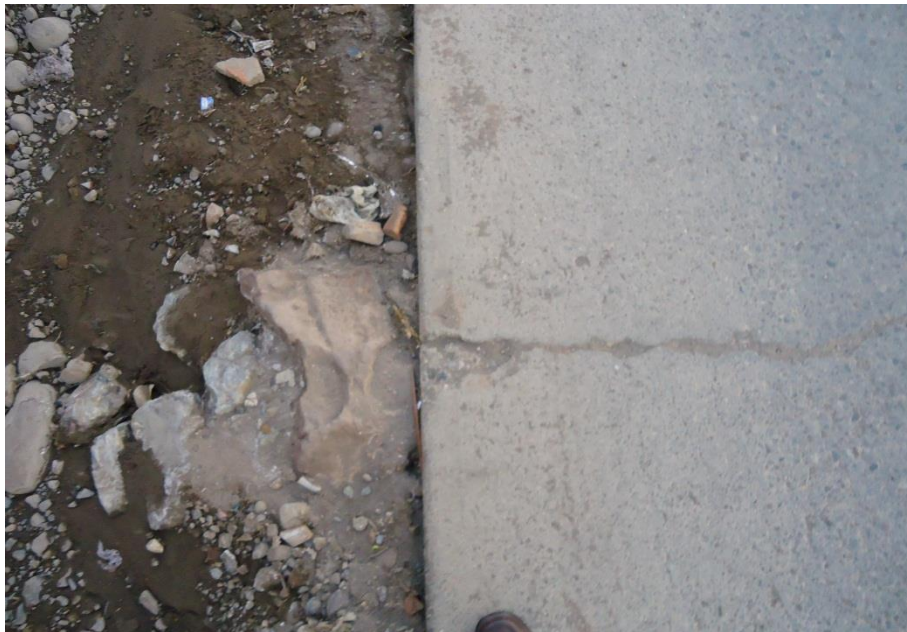
Figura N°13. Deterioro de Berma
