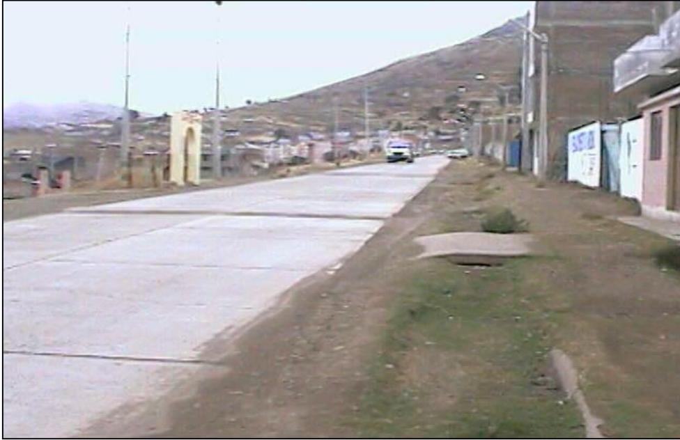
Figura N°07. Cuneta colmatada en su totalidad
