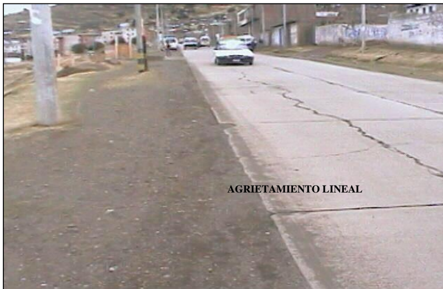
Figura N°11. Agrietamiento lineal de severidad alta
