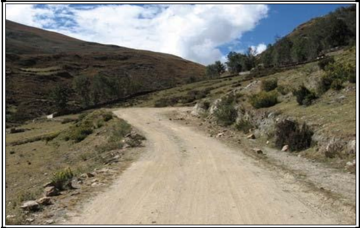
Figura N°03 se observa en la figura el mal estado de la plataforma
