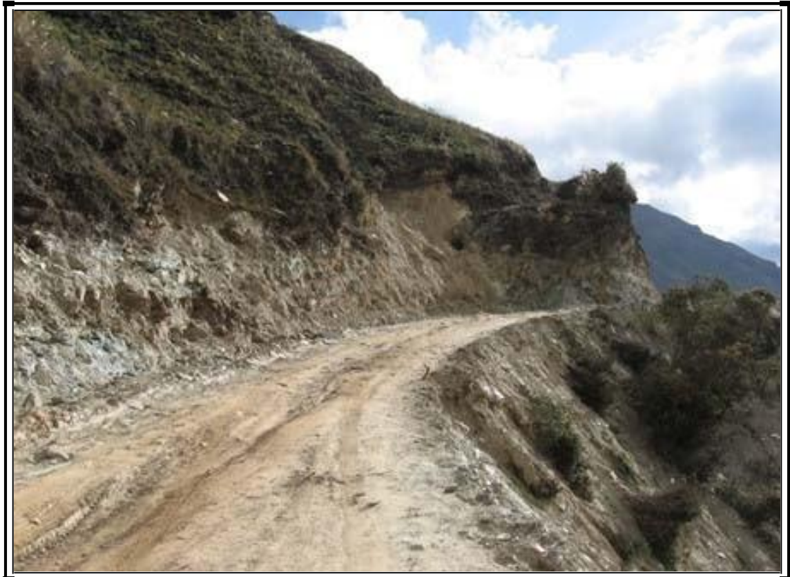
Figura N°04 se observa en la figura el mal estado de la plataforma
