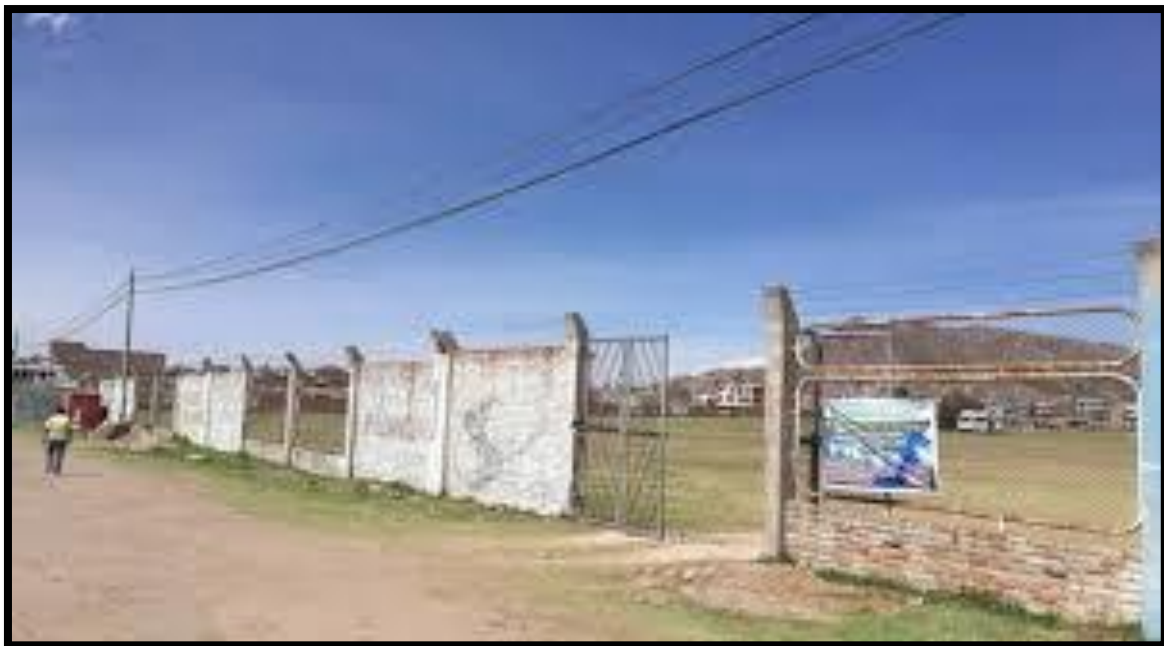
Imagen 02.- Se observa el descuido del cerco perimétrico
