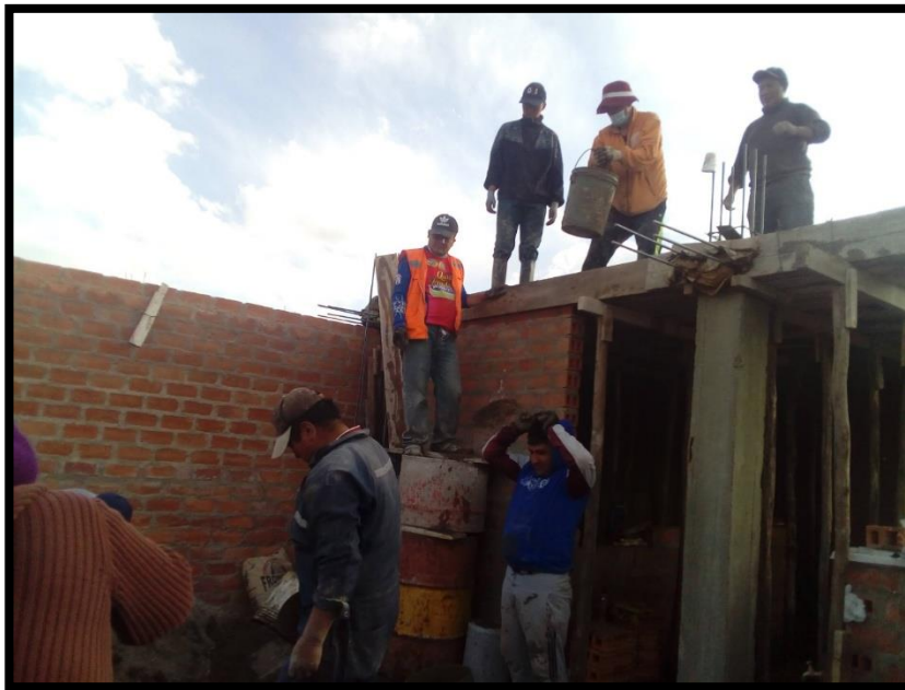
Figura N° ...: Personal sin EPP en techo de losa aligerada
