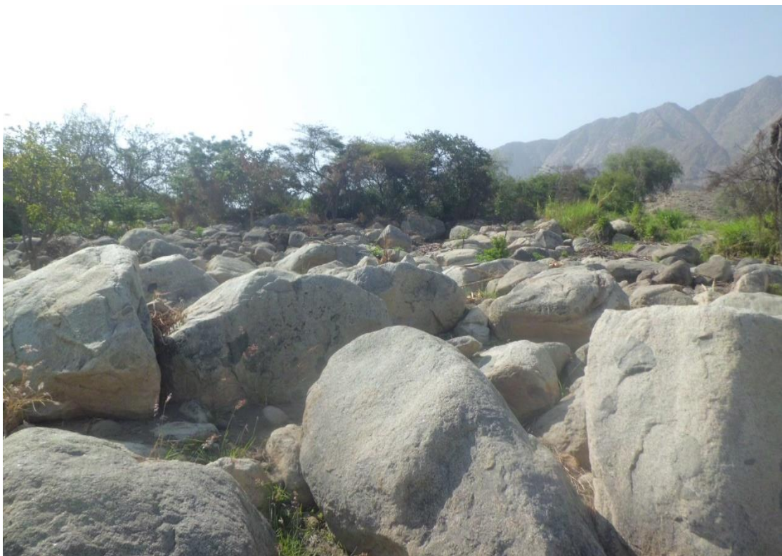
FOTO N°04 SE OBSERVA LA EROSION EN LOS TRABAJOS DE ENROCADO
