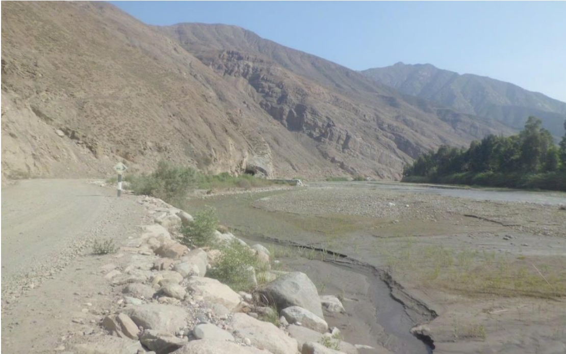
FOTO N°03 SE OBSERVA LA EROSION EN LOS TRABAJOS DE ENROCADO
