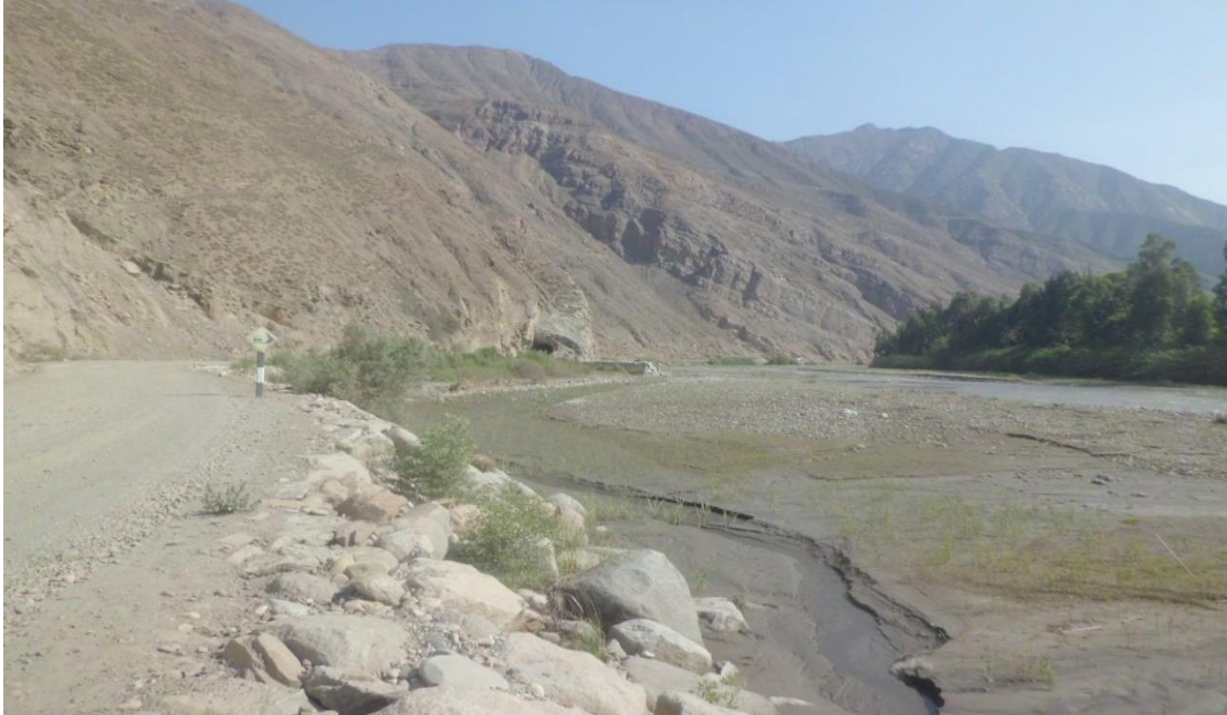
FOTO N°04 SE OBSERVA LA EROSION EN LOS TRABAJOS DE ENROCADO
