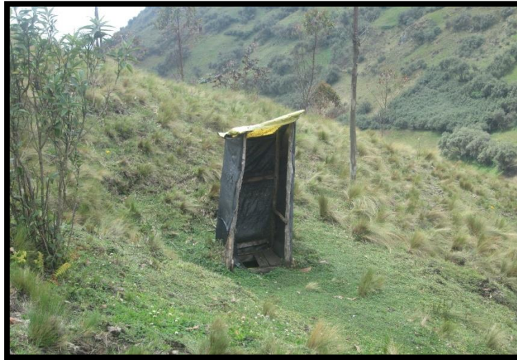
IMAGEN 07: LETRINA SECA EN MAL ESTADO (CHAQUICOCHA)
