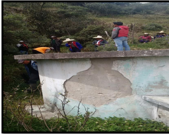
IMAGEN 01: RESERVORIO (AHIJADERO) EN MAL ESTADO
