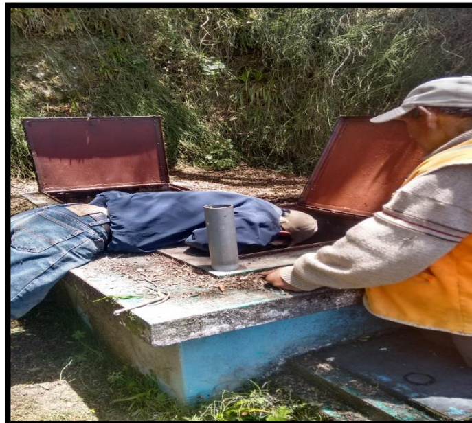
IMAGEN 04: CAPTACION DE AHIJADERO
