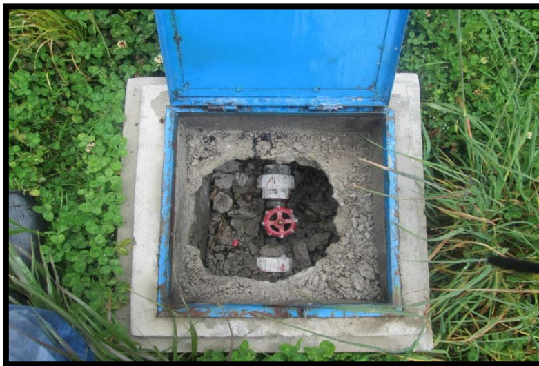
IMAGEN 02: VALVULA DE CONTROL EN MAL ESTADO (AHIJADERO)
