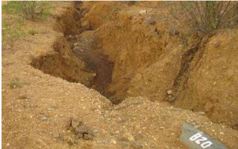
FIGURA N a 04: Erosión de los suelos causado por derrumbes
