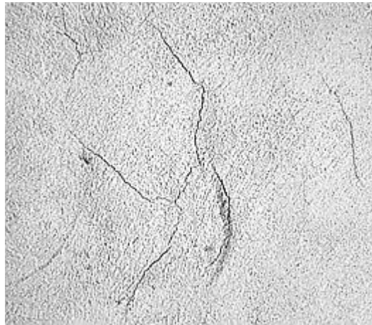
Figura 4. Fisuración por retracción plástica.
