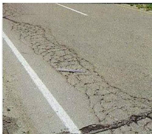
Figura 9. Fisuras piel de cocodrilo
