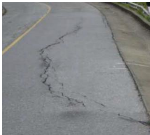
Figura 12. Fisura en arco
