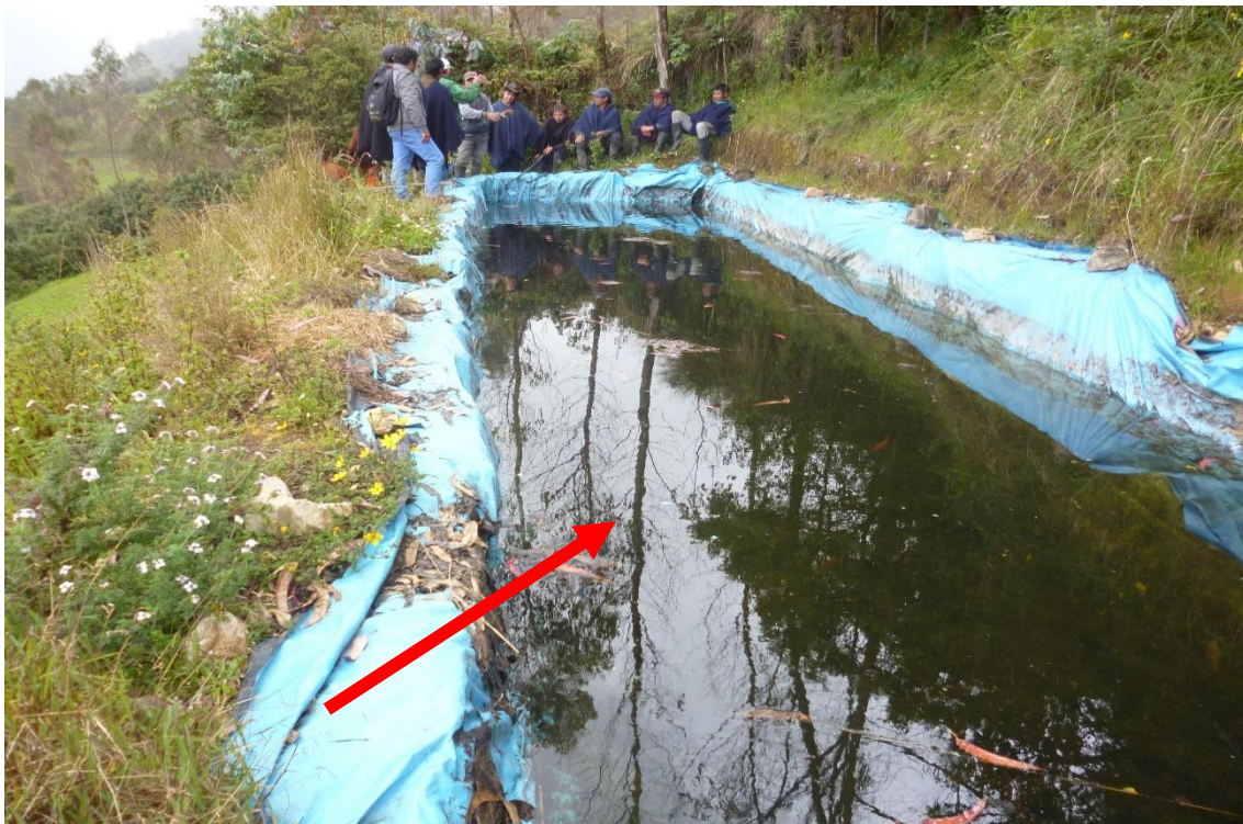
Figura 11 Vista de los micro reservorios artesanales, donde no se aprecia que no están perfilados y usan plástico para evitar su filtración hacia el suelo. Fuente: elaboración propia
