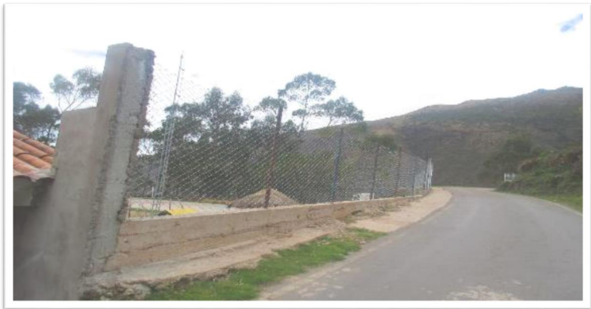
Figura 46. Vista del cerco perimetrico en mal estado y poneindo en riesgo a los alumnos que estudian dicho centro de estudios
