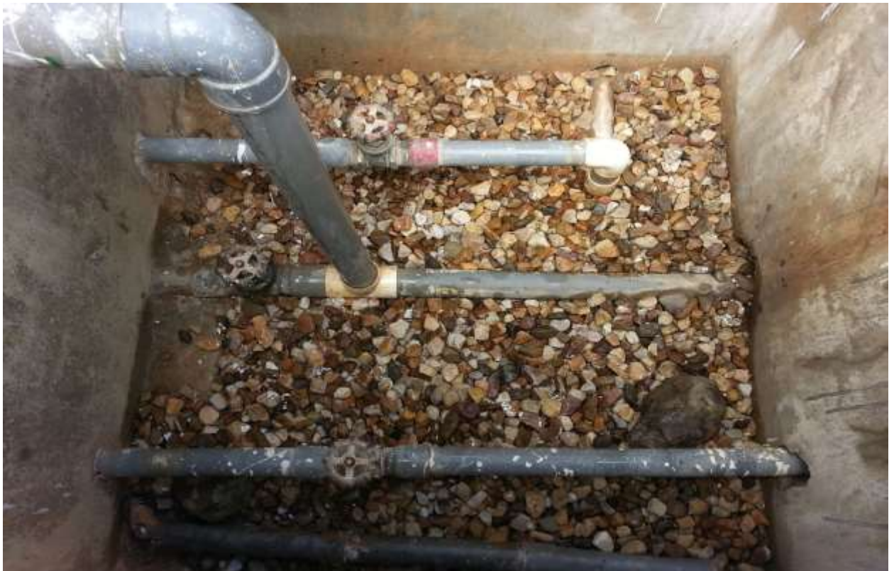
FOTO N° 08. - VISTA INTERIOR DE CASETA DE VALVULAS DE RESERVORIO
