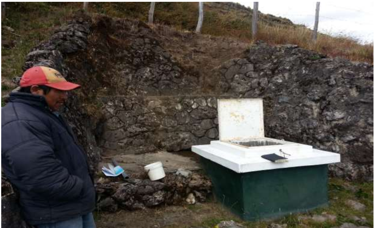
FOTO N° 02. - CAPTACION N° 2 "LA COLPA".
