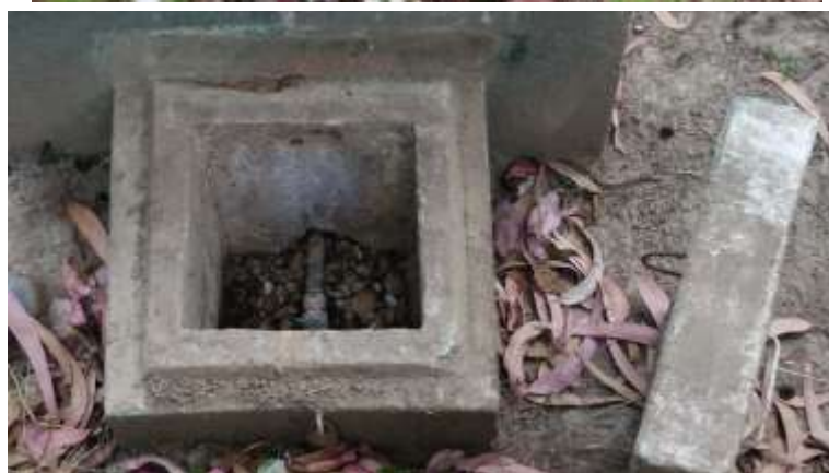
FOTO N° 20. - VALVULAS EN CRP T-7.
