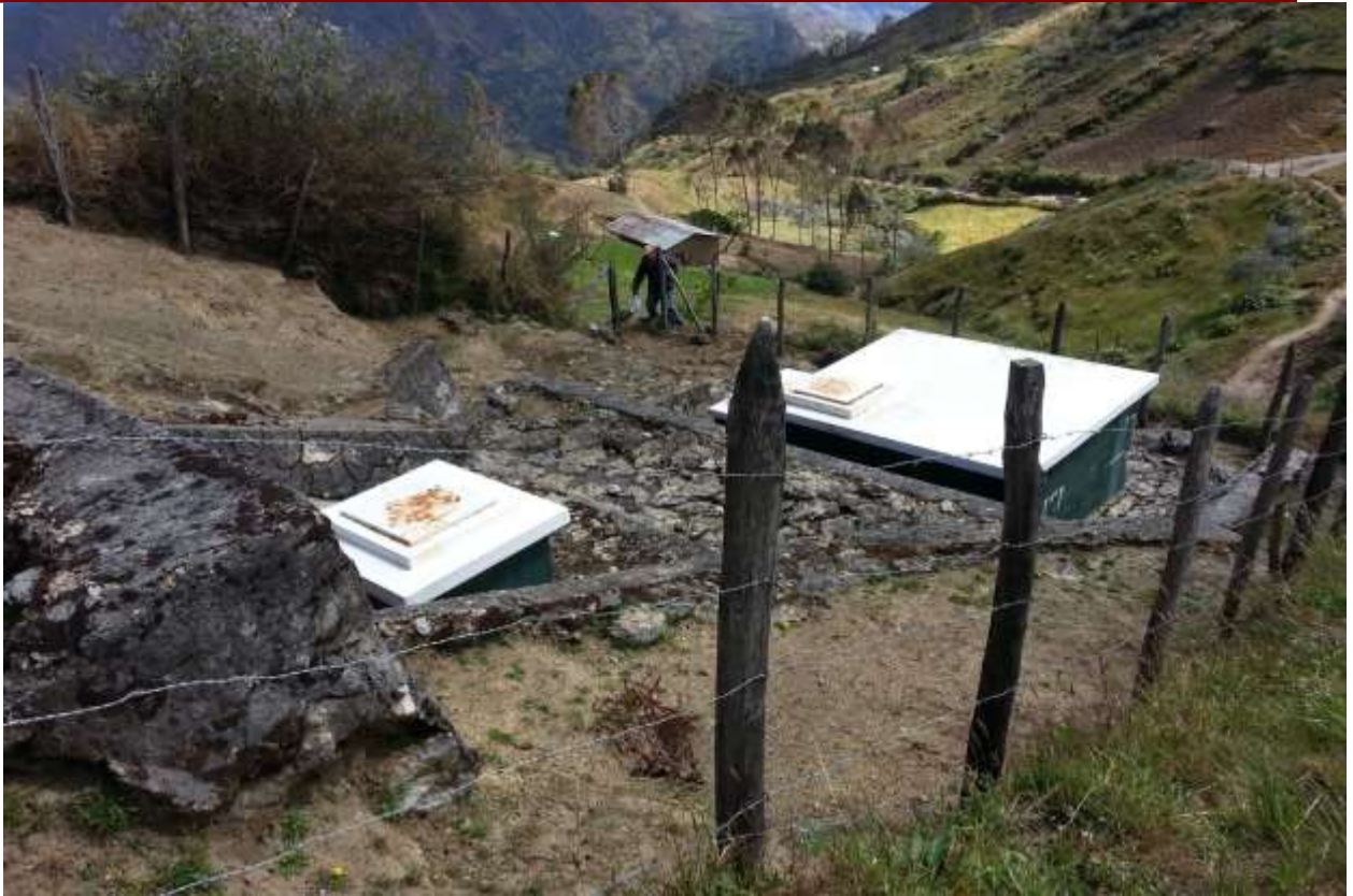
FOTO N° 05. - CAPTACION N° 1 “UÑIGAN” Y EL RESERVORIO DE 10M3.
