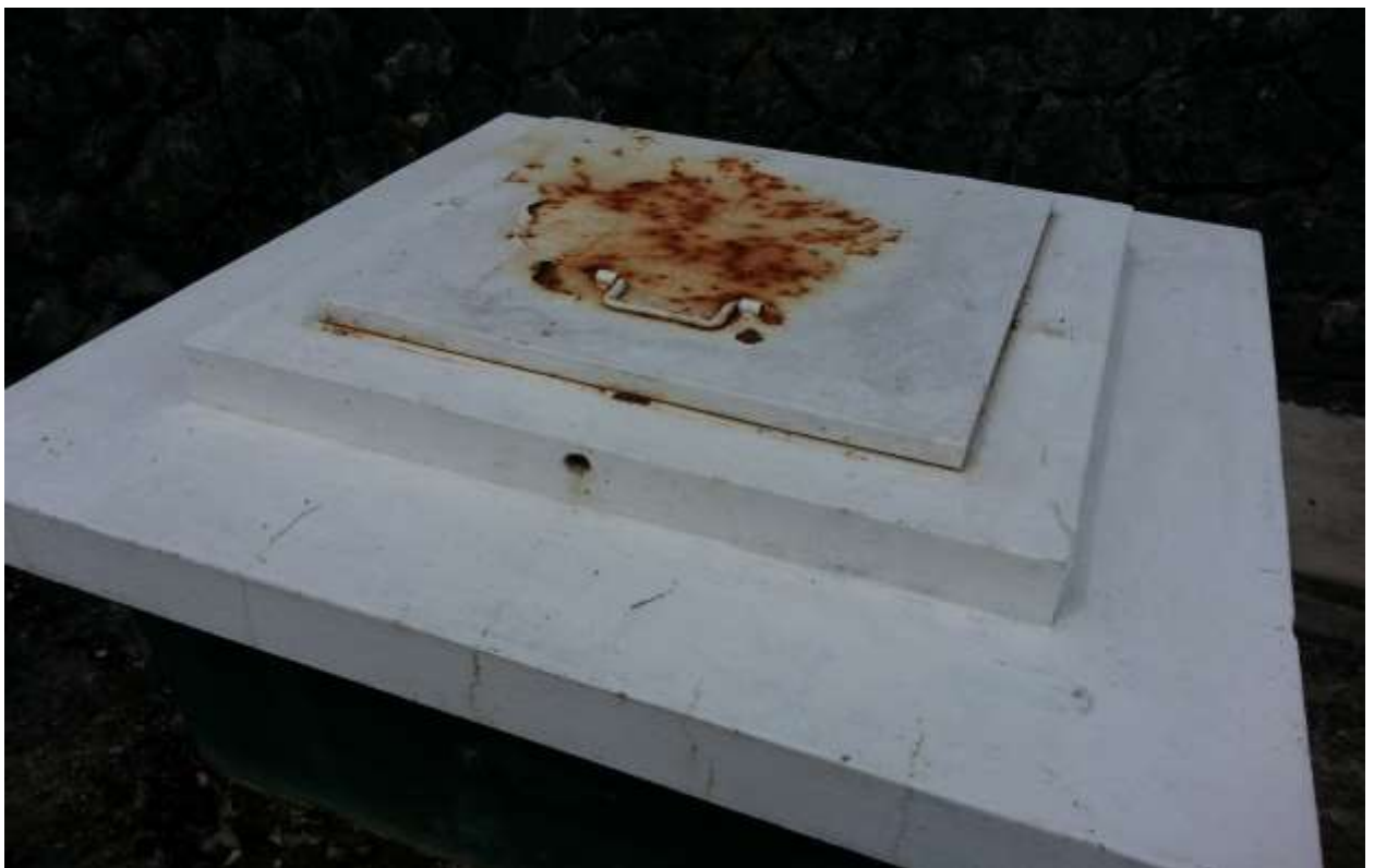
FOTO N° 12. - VISTA DE TAPA METALICA DE CAPTACIONES
