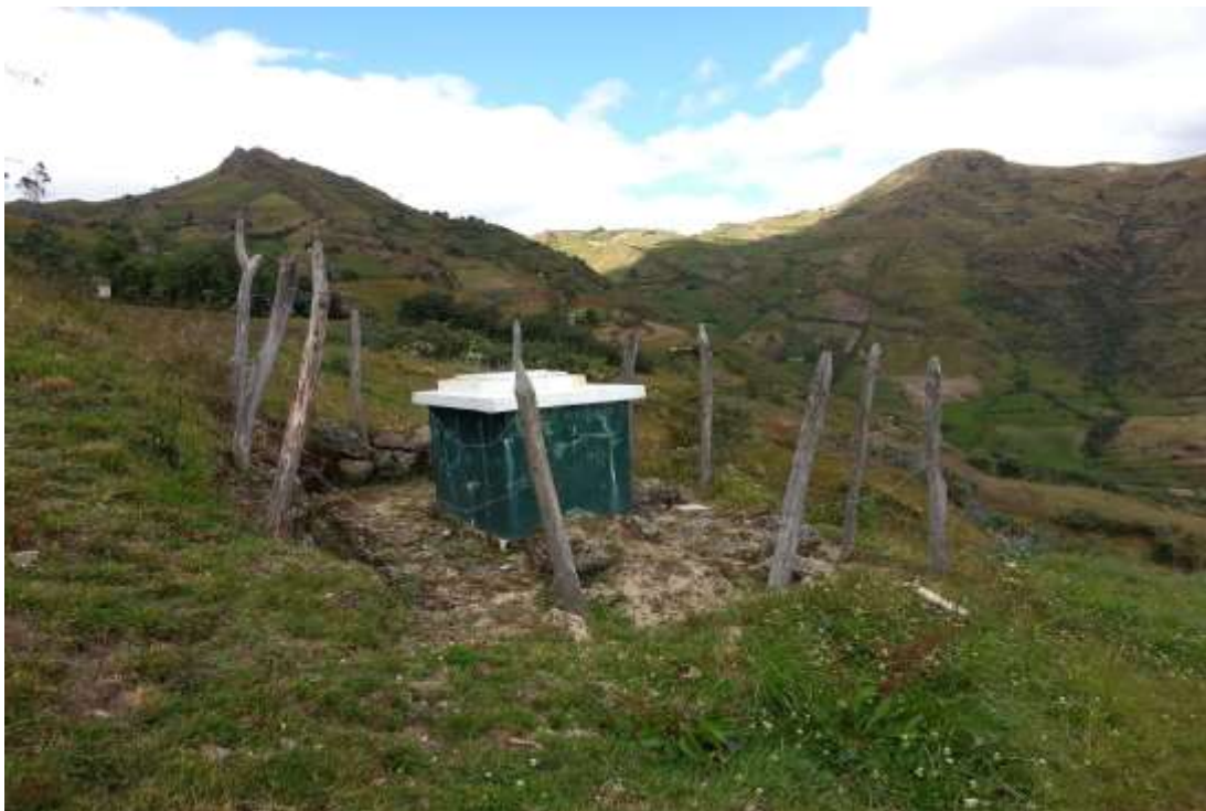
FOTO N° 18. - VISTA DE CRP T-7 EN RED DE DISTRIBUCION
