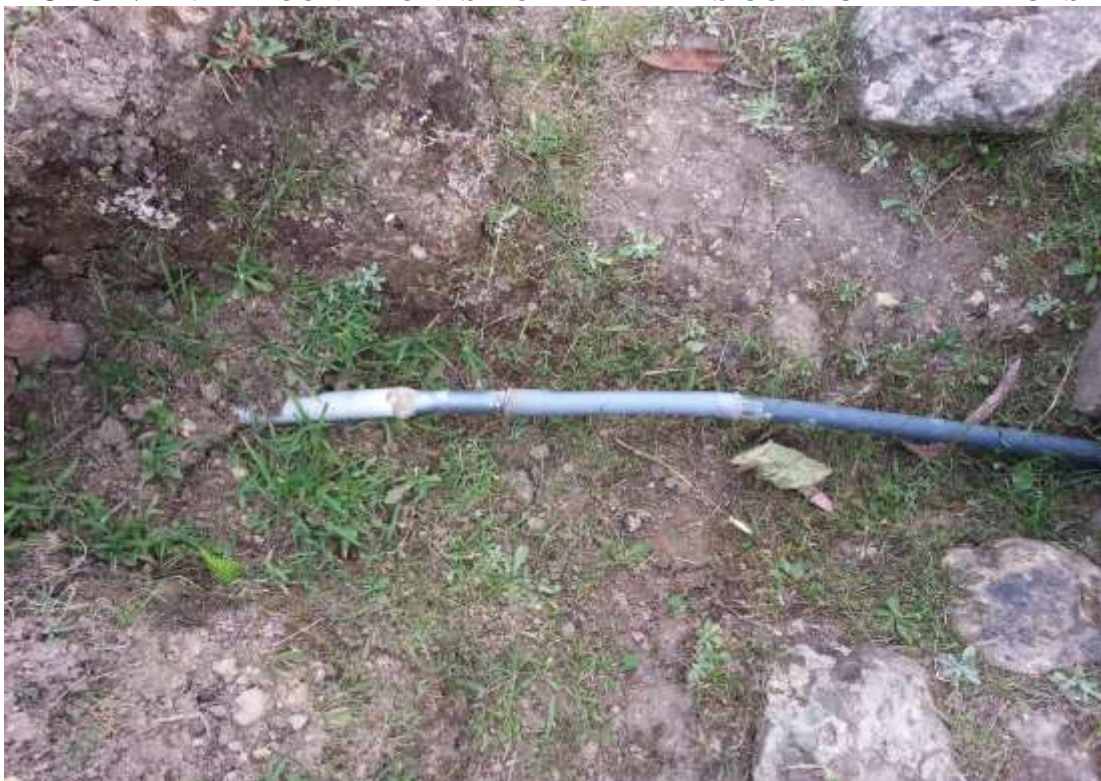
FOTO N° 22. - TUBERIA EXPUESTA EN RED DE DISTRIBUCION
