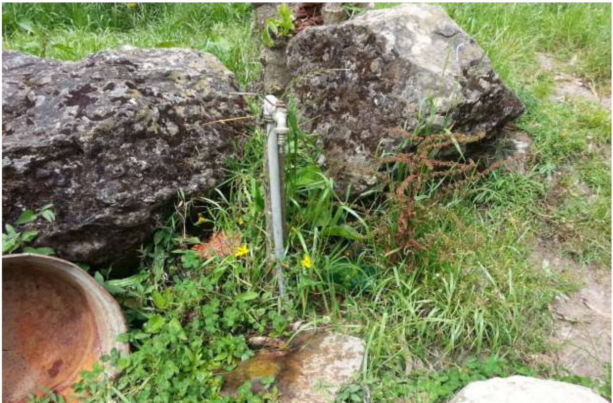
FOTO N° 16. - CONEXIONES DOMICILIARIAS SIN PILETAS.
