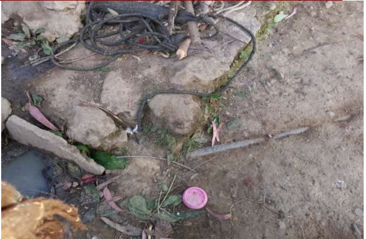
FOTO N° 21. - CONEXIONES DOMICILIARIAS CON TUBERIA EXPUESTA.
