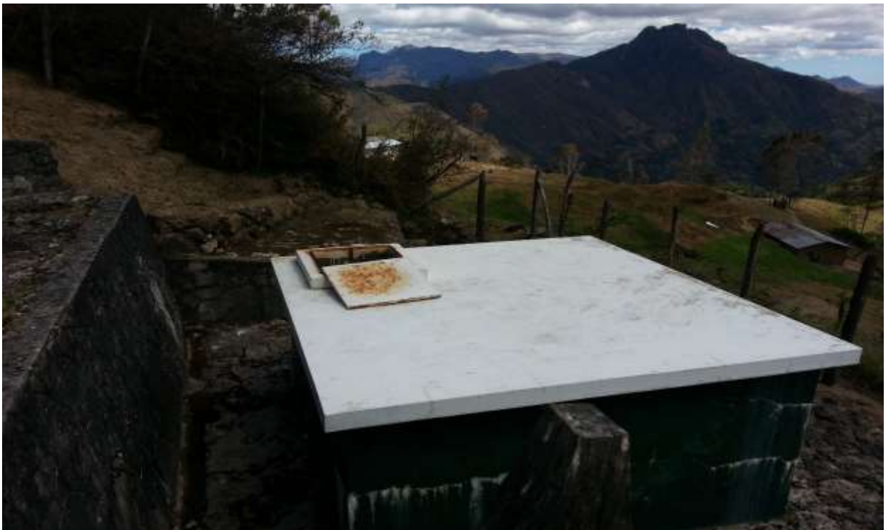
FOTO N° 06. - VISTA DE RESERVORIO DE 10M3
