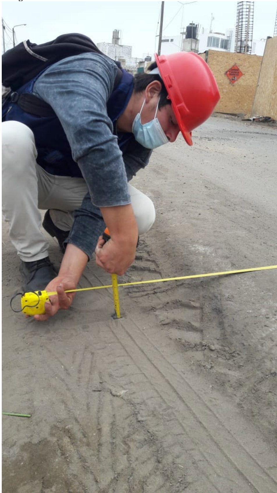
Fotografía N° 04: Desnivel Carril/ Berma
