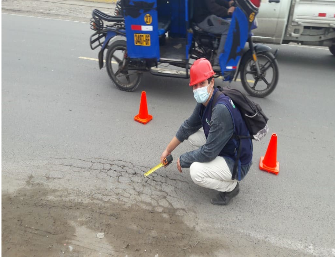
Fotografía N° 01: Agrietamiento en bloque
