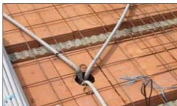
Figura 07: Instalaciones eléctricas con viguetas pretensadas
