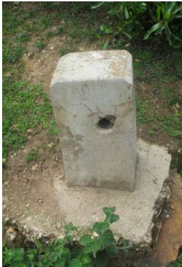
FOTO N° 20. - Vista de TUBO ROMPE CARGA en mal estado en línea de conducción
