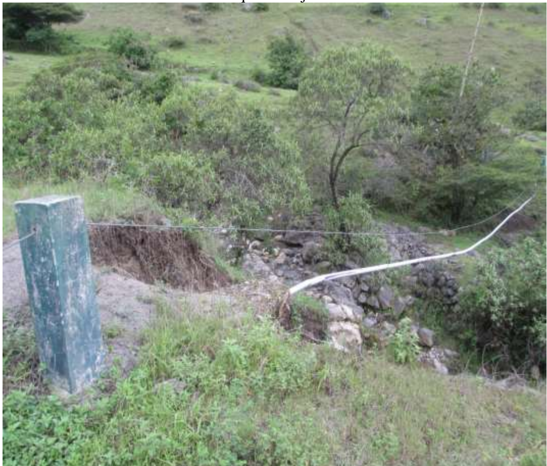
FOTO N° 18. - Verificación de PASE AEREO, L=18.50 ML, se aprecia la estructura de concreto con rajaduras y la tubería rota.
