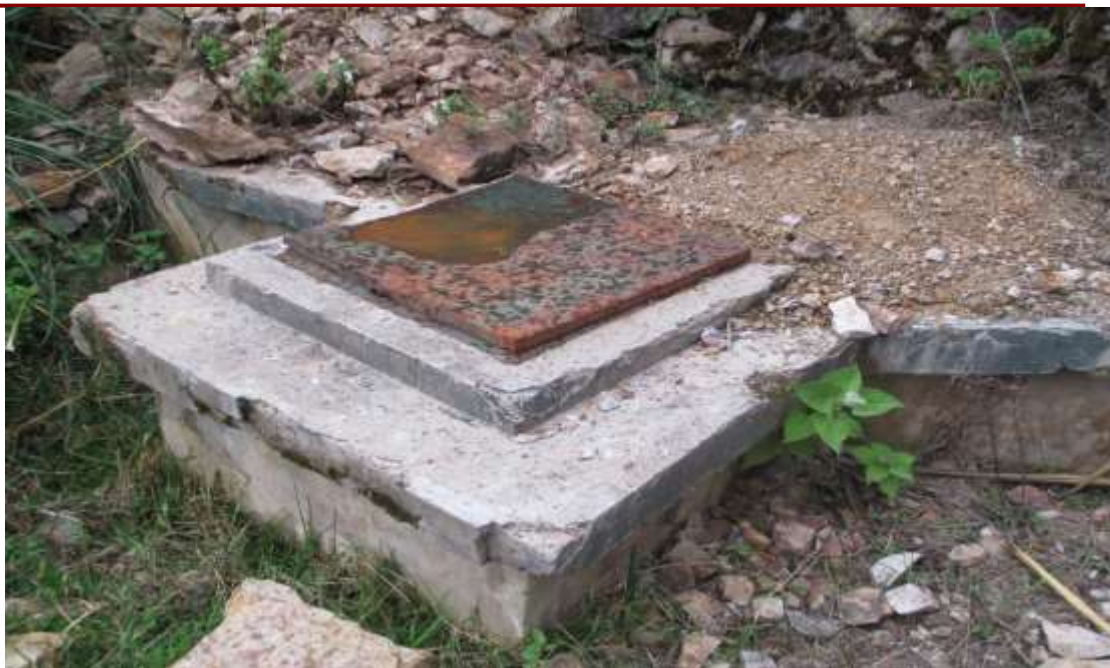
FOTO N° 03. - Verificación de la CAPTACION N° 2 “MAL PASO”, se observa estructuras deterioradas por el tiempo (Construidas hace más de 20 años). Se requiere demolición y reconstrucción.
