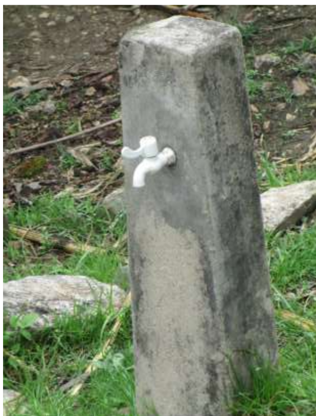
FOTO N° 22. - Pileta deteriorada en el sector “CATILLAMBI”
