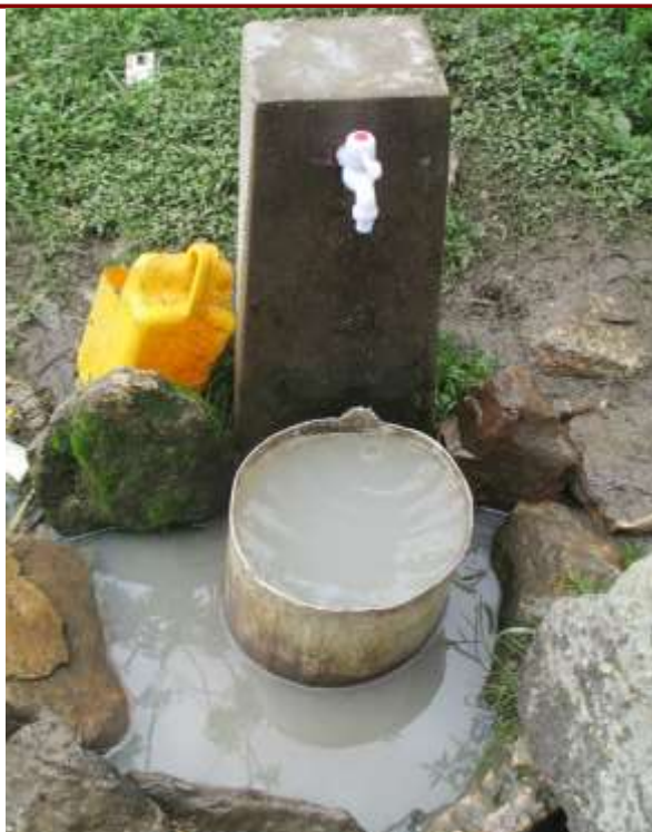
FOTO N° 21. - Pileta deteriorada en el sector “MOLLEPATA ALTA”
