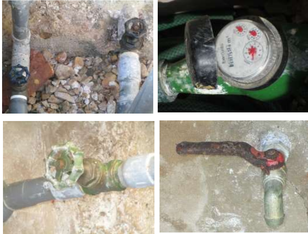
FOTO N° 07. - Verificación de accesorios deteriorados en Caseta de Válvulas de RESERVORIO N° 1 (V=8M3). Se requiere construcción y cambio de accesorios.
