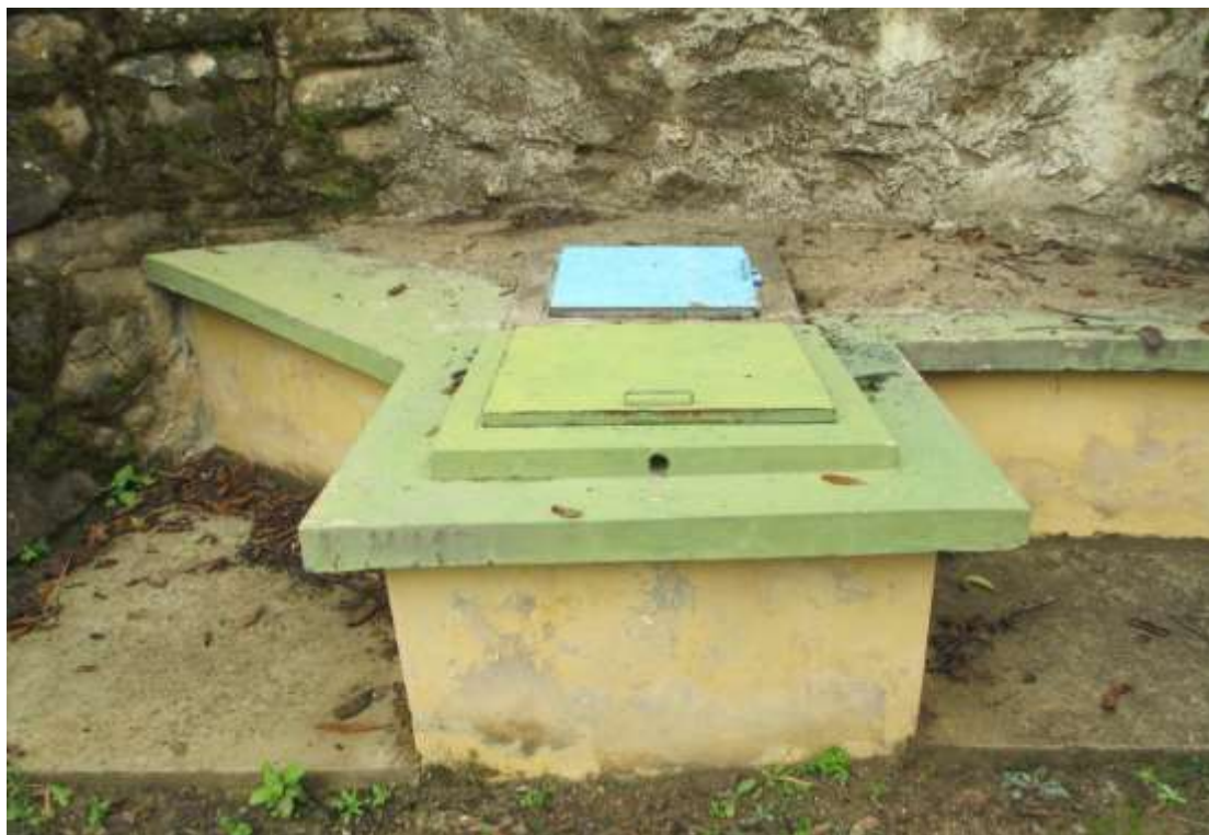
FOTO N° 01. - Verificación de la CAPTACION N° 1 “MONTEGRANDE”, se observa las tapas metálicas en malas condiciones con presencia de óxido, estructura de concreto en buen estado. Se requiere mejoramiento...
