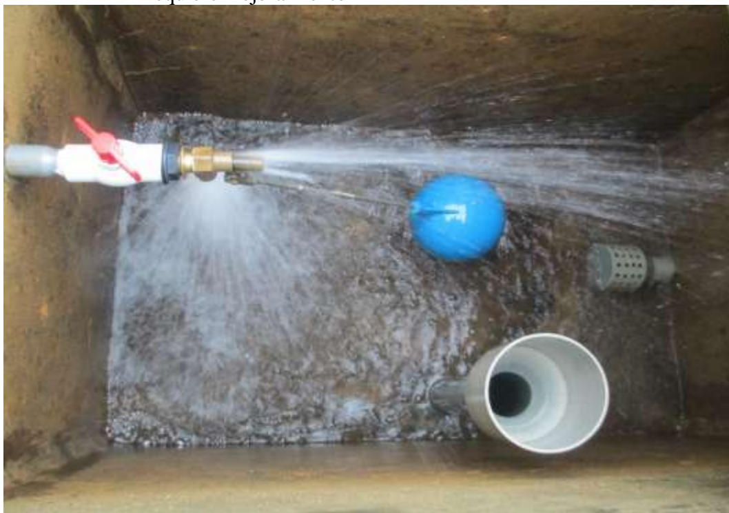
FOTO N° 12. - Vista interior de CAMARA ROMPE PRESION TIPO 7, válvula flotadora en mal estado. Se requiere mejoramiento.
