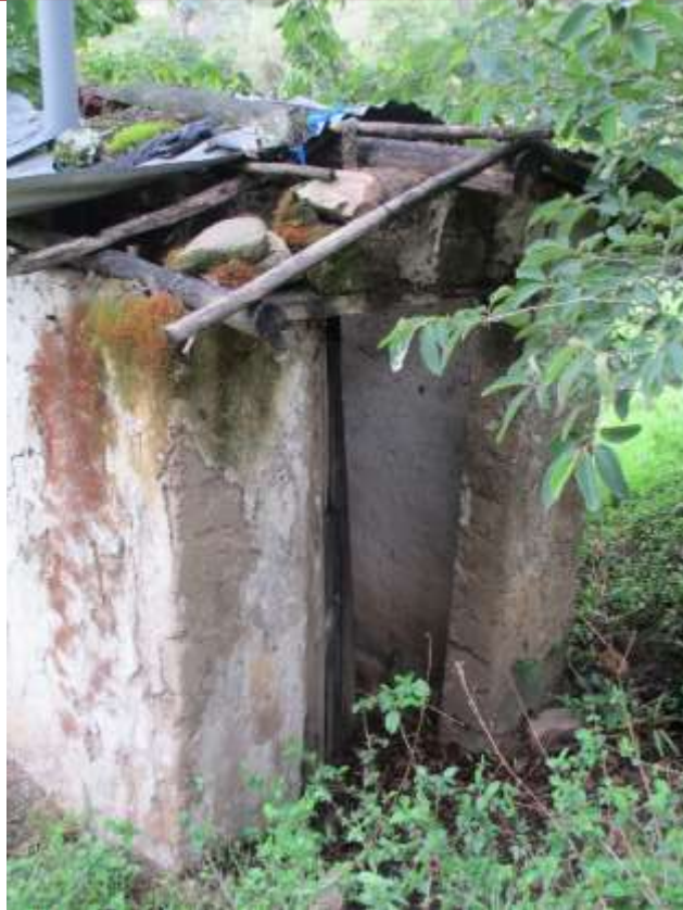
FOTO N° 23. - Letrina de Hoyo Seco Ventilado colapsada
