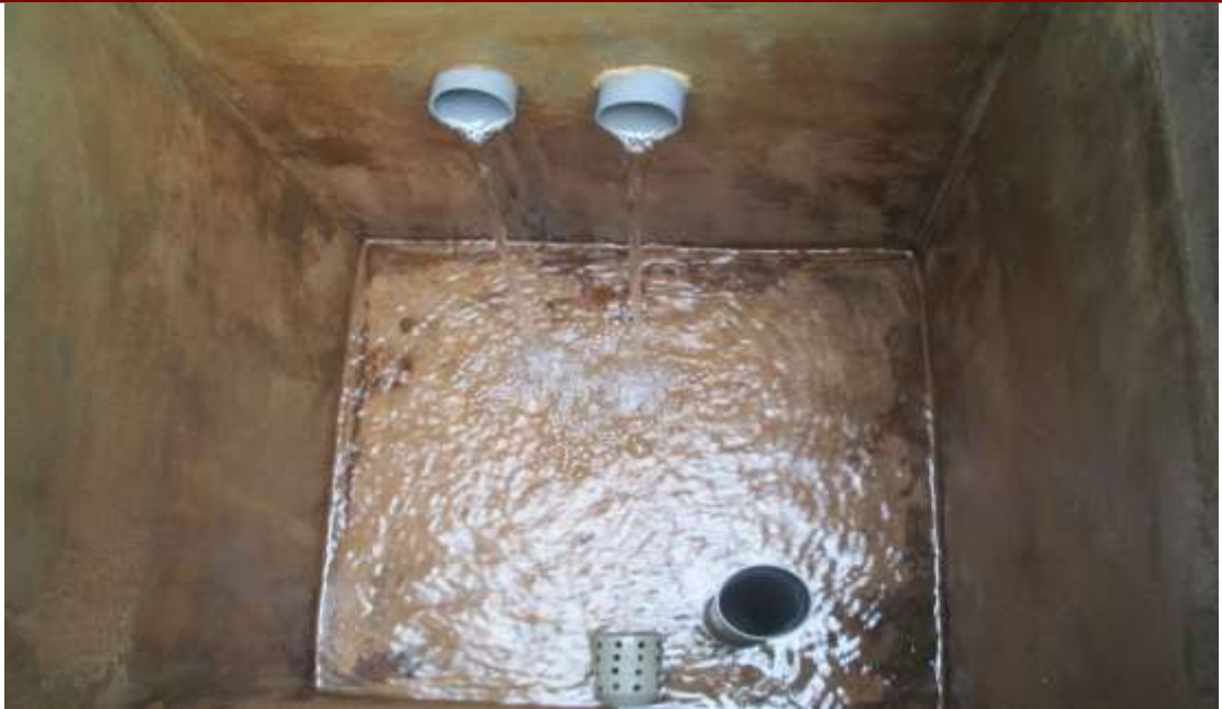
FOTO N° 17. - Vista interior de la CAPTACION N°5 “LA SHITA”, se aprecia la falta de accesorios. Se requiere mejoramiento.
