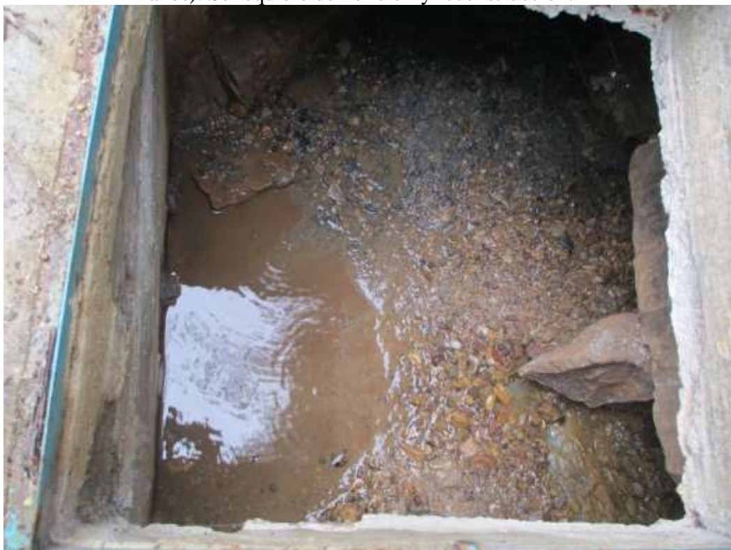
FOTO N° 04. - Vista Interior de la CAPTACION N° 2 “MAL PASO”, se observa estructuras deterioradas por el tiempo (Construidas hace más de 20 años).
