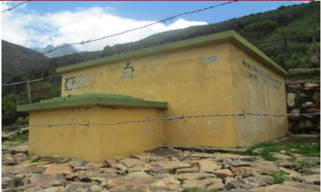
FOTO N° 05. - Verificación del RESERVORIO N° 1 SECTOR “KEROPUSPO”, V=8M^3 . Como se puede apreciar la estructura se encuentra en buen estado estructural. Se requiere mejoramiento.
