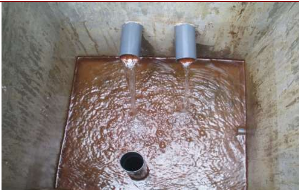
FOTO N° 15. - Vista interior de la CAPTACION N° 4 “LA GRANADILLA”, se puede apreciar la falta de accesorios. Se requiere mejoramiento.
