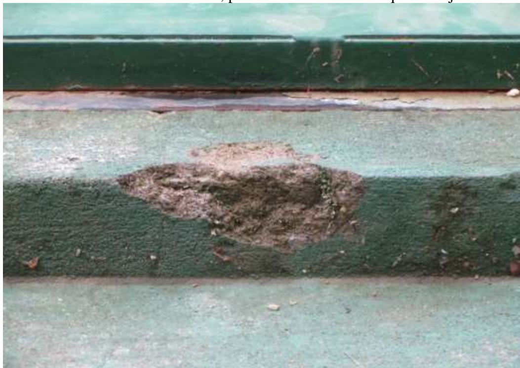
FOTO N° 10. - Vista de CASETA DE VALVULAS DE RESERVORIO N° 02. Estructura en mal estado. Se requiere demolición y reconstrucción.
