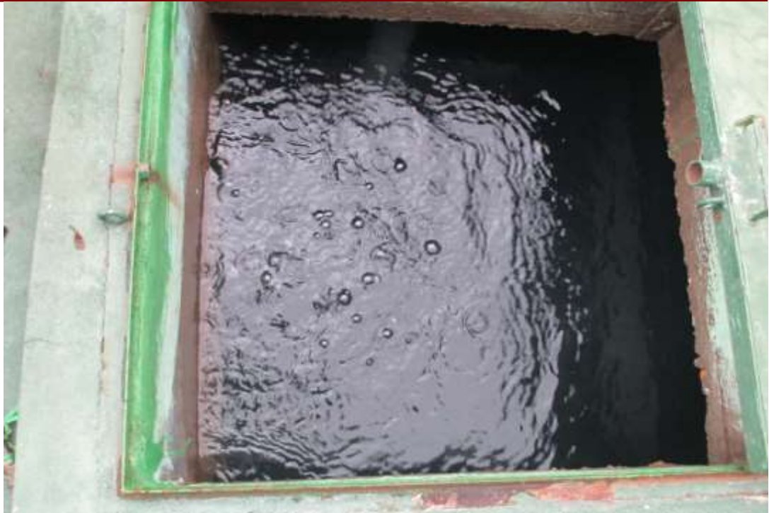
FOTO N° 9. - Vista interior de RESERVORIO N° 2 (V=12M3). Tapa metálica en malas condiciones, presencia de óxido. Se requiere mejoramiento.
