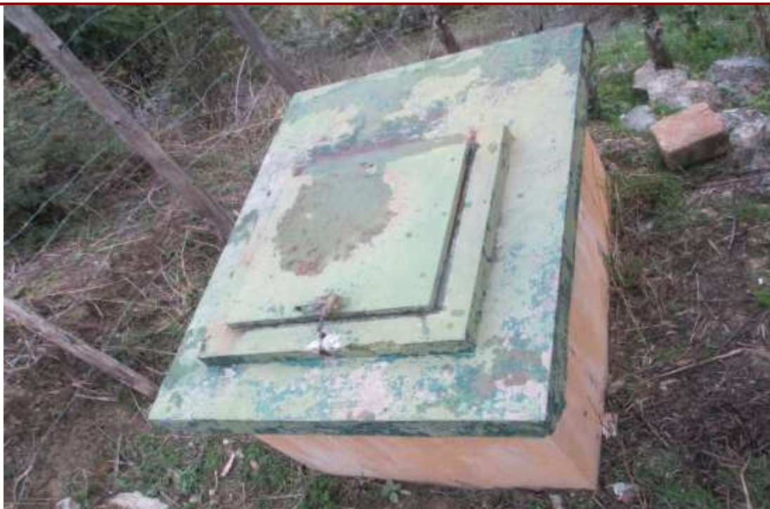
FOTO N° 11. - Vista de CAMARA ROMPE PRESION TIPO 7. Tapa metálica en mal estado, presencia de despostilladuras en la estructura de concreto. Se requiere mejoramiento
