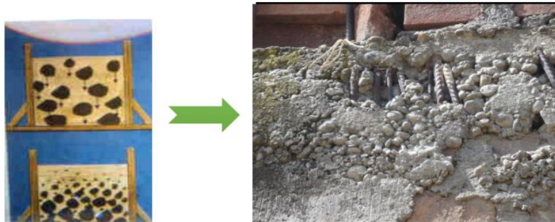
Figura 36. Segregación del concreto.
