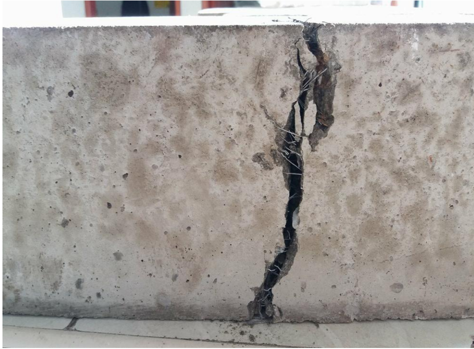
Anexo N° 34. Viga con fibras.
