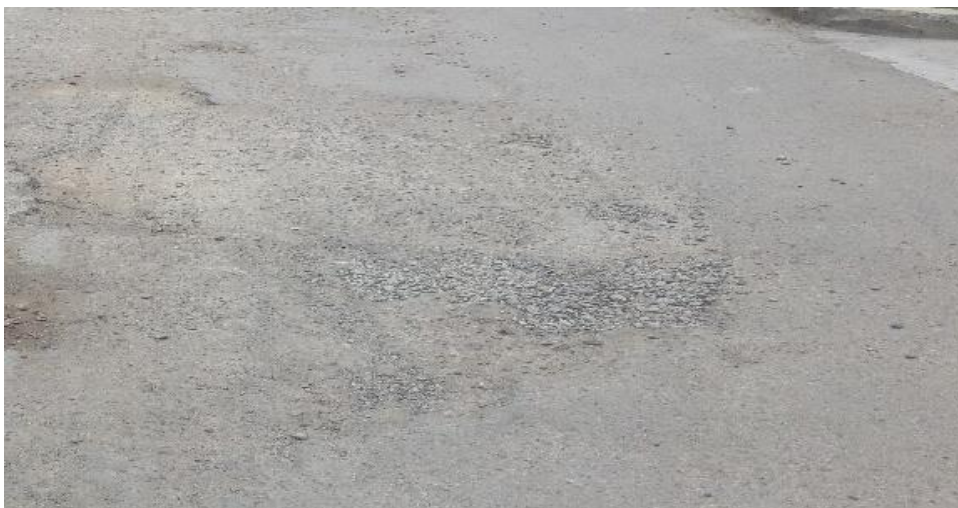
Imagen: 28 Desprendimiento de agregados
