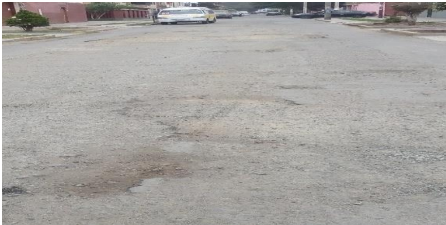
Ilustración 13 Desprendimientos de Agregados.
