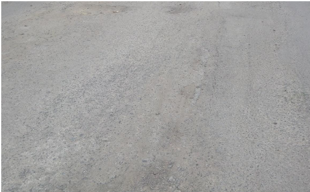
Imagen: 19 Desprendimiento de Agregados
