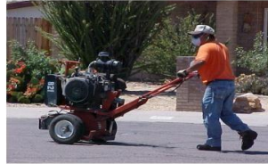
Ruteado de la grieta
