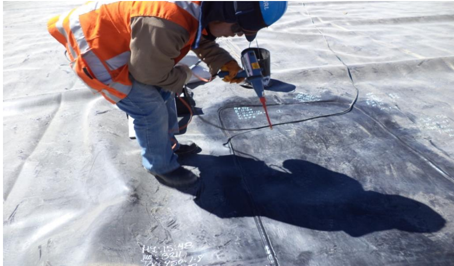
Figura 07 Prueba de chispa o “spark test”
