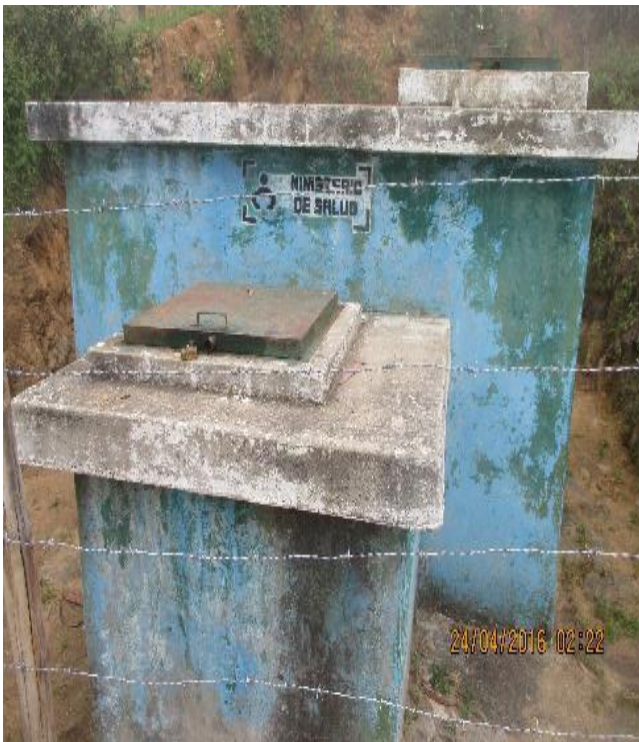
Foto N°03 Reservorio en mal estado
