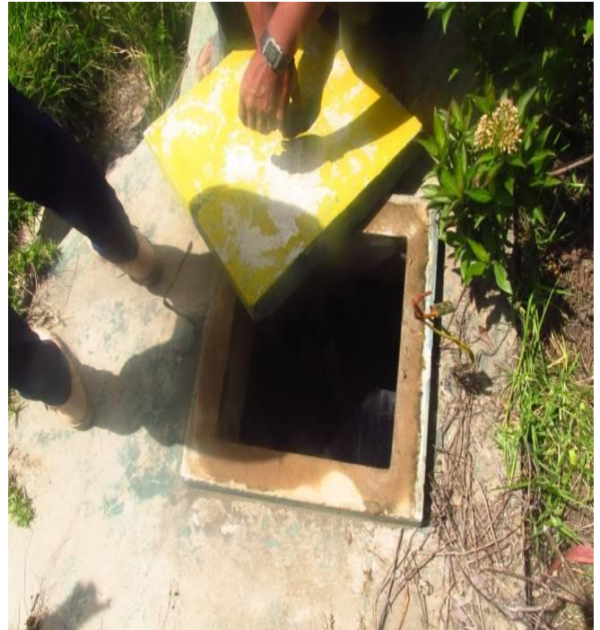
Foto N°02 Cámara Rompe Presión
