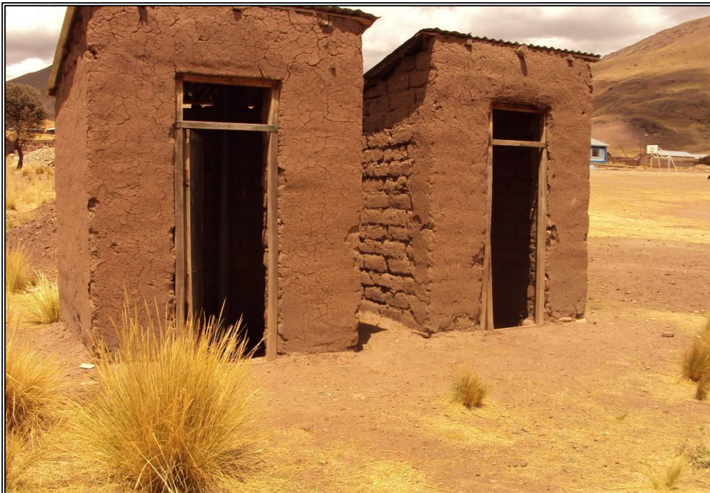
Foto N° 04.- Letrinas del tipo hoyo seco ubicadas en el centro educativo primario de Caluyo, que alberga a 60 alumnos..
