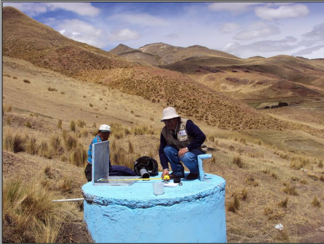
Foto Nº 05.- Reservorio circular existente (almacena reducida capacidad de agua proveniente de la fuente Lulihuachana) ubicado en la zona alta de Caluyo, presenta fisuras en el techo y muros, no cuenta con adecuada caja de válvulas y carece de accesorios, cero perimétrico y 17 años de antigüedad.
