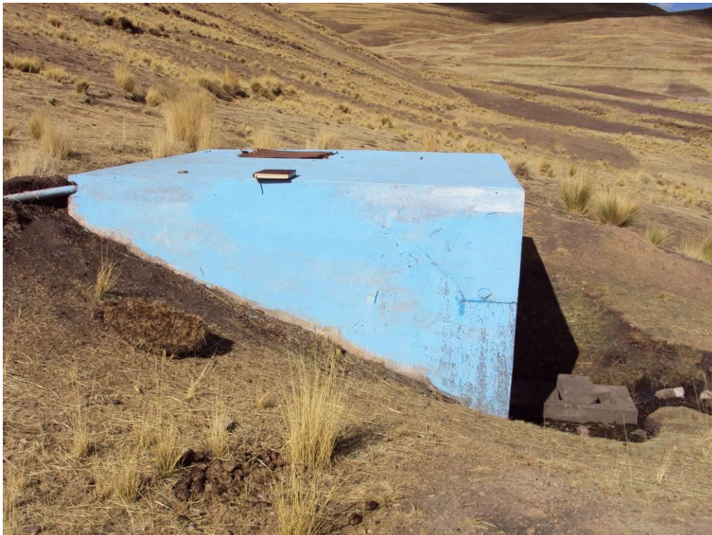
Foto Nº 06.- Reservorio existente de forma cuadrada (almacena agua proveniente de la fuente Occocata), con problemas de filtración alrededor de la estructura, y dimensionamiento incorrecto de la caja de válvulas, con carencia y deterioro de accesorios, sin cerco perimétrico, y 17 años de antigüedad.
