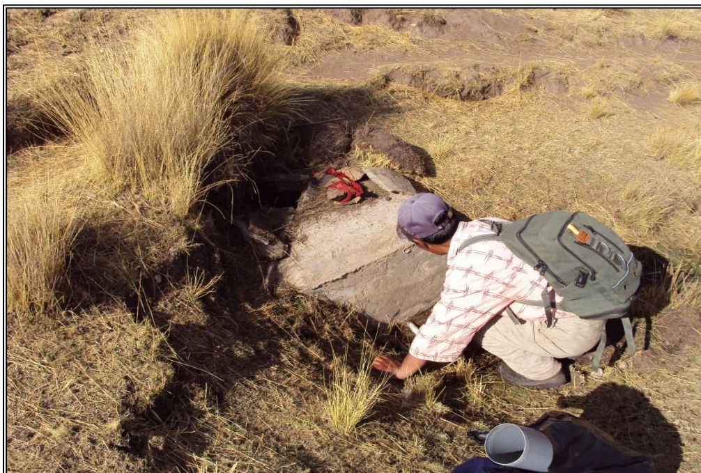
Foto N°02.- Captación existente, Occocata, se encuentra semienterrado, construcción rústica, en mal estado, con fisuras, no presenta accesorios como válvula de salida, canastilla, cono de rebose, no opera eficientemente, tiene 17 años de antigüedad, y no tiene cerco perimétrico.
