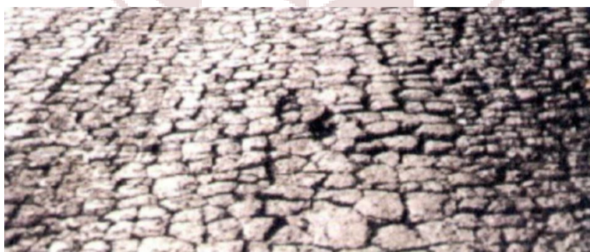
Figura 4: Piel de cocodrilo. Fuente: Ministerio de Transportes y Comunicaciones. (2014)
