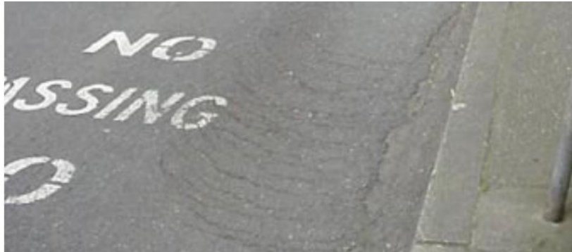
Figura 20: Fisura parabólica o por deslizamiento (Slippage). Fuente: Corros, Maylin. Urbacz, Ernesto. Corredor, Gustavo (2009)
