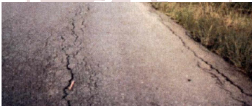
Figura 13: Grietas longitudinales y transversales. Fuente: Ministerio de Transportes y Comunicaciones. (2014)
