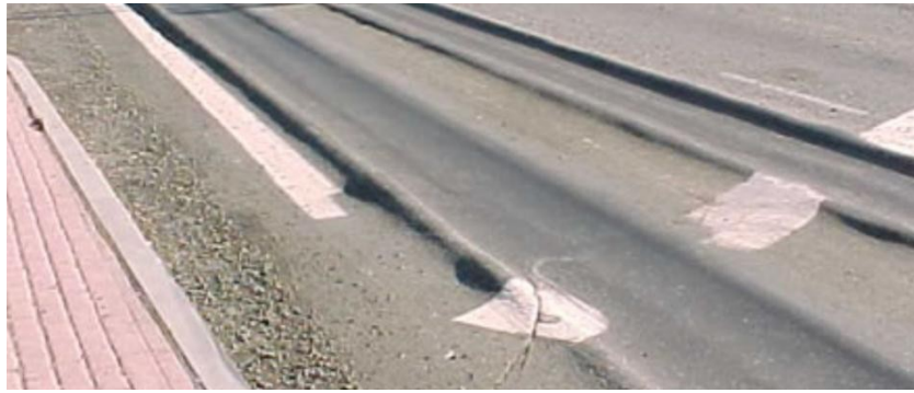
Figura 18: Ahuellamiento. Fuente: Corros, Maylin. Urbaez, Ernesto. Corredor, Gustavo (2009)
