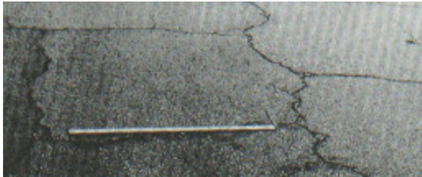
Figura 6: Agrietamiento en bloque. Fuente: Vásquez, L. (2002)
