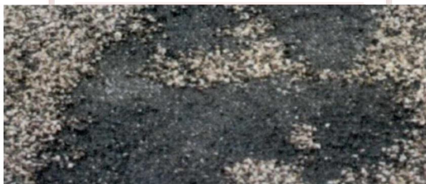
Figura 22: Peladura por intemperismo y desprendimiento de agregados. Fuente: Ministerio de Transportes y Comunicaciones. (2014)
