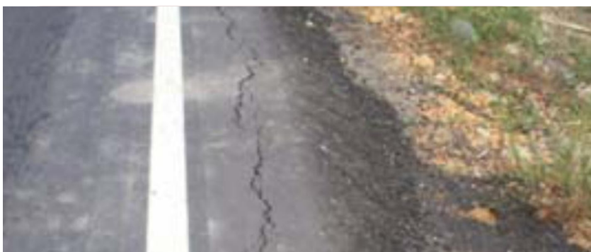
Figura 10: Grieta de borde. Fuente: Corros, Maylin. Urbaez, Ernesto. Corredor, Gustavo (2009)
