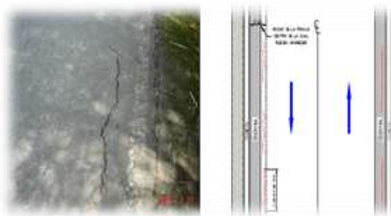
Figura 10: Fisuras de Borde
