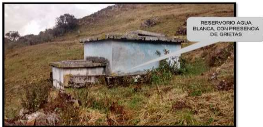
IMAGEN 02: RESERVORIO EN MAL ESTADO AGUA BLANCA
