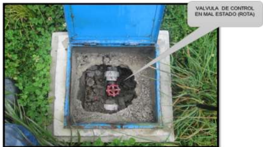
IMAGEN 03: VALVULA DE CONTROL AGUA BLANCA
