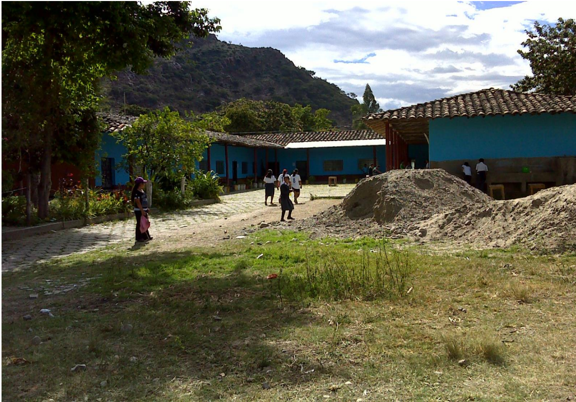
Foto N° 24: Techo de 2 aguas de aulas de la I.E. Carlos Manuel Cox Rosse - Cholocal, cajabamba
