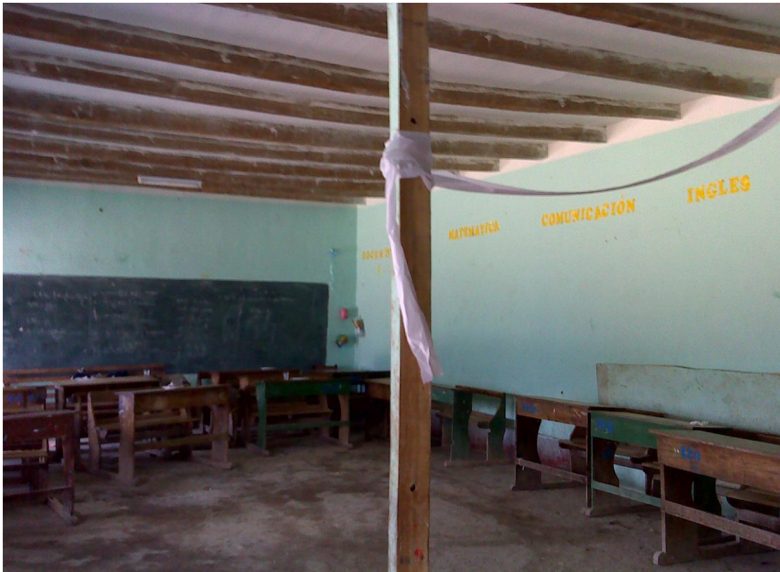
Foto N° 22: Techo de aulas de la I.E. Carlos Manuel Cox Rosse - Cholocal, Cajabamba
